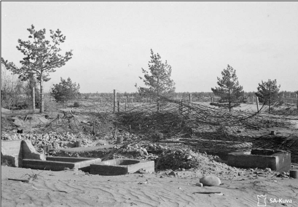
Kuva 11. Keskeneräinen betonibunkkerin rakennustyömaa Lappohjassa lokakuussa 1942. Kuopan pohjalle on ehditty valaa betonisia kaivorakenteita ym. Kuopan reunalla on betonivalujen vahvistamiseen tarkoitettua pyöröteräsvärkkoa. Kuva 114156. Alarik Öhrnberg. Sa-kuva-arkisto.
