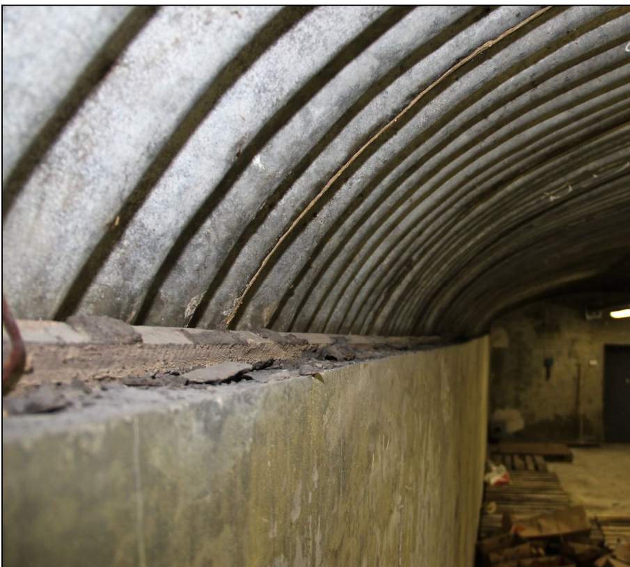
Kuva 19. Luolan G6 varastotila. Aaltopeltikatto on kiilattu alareunastaan lankulla betoniseinän ja kalliopinnan väliin. Kuvattu etelän suuntaan. Kuva: AKDG49189:22.
