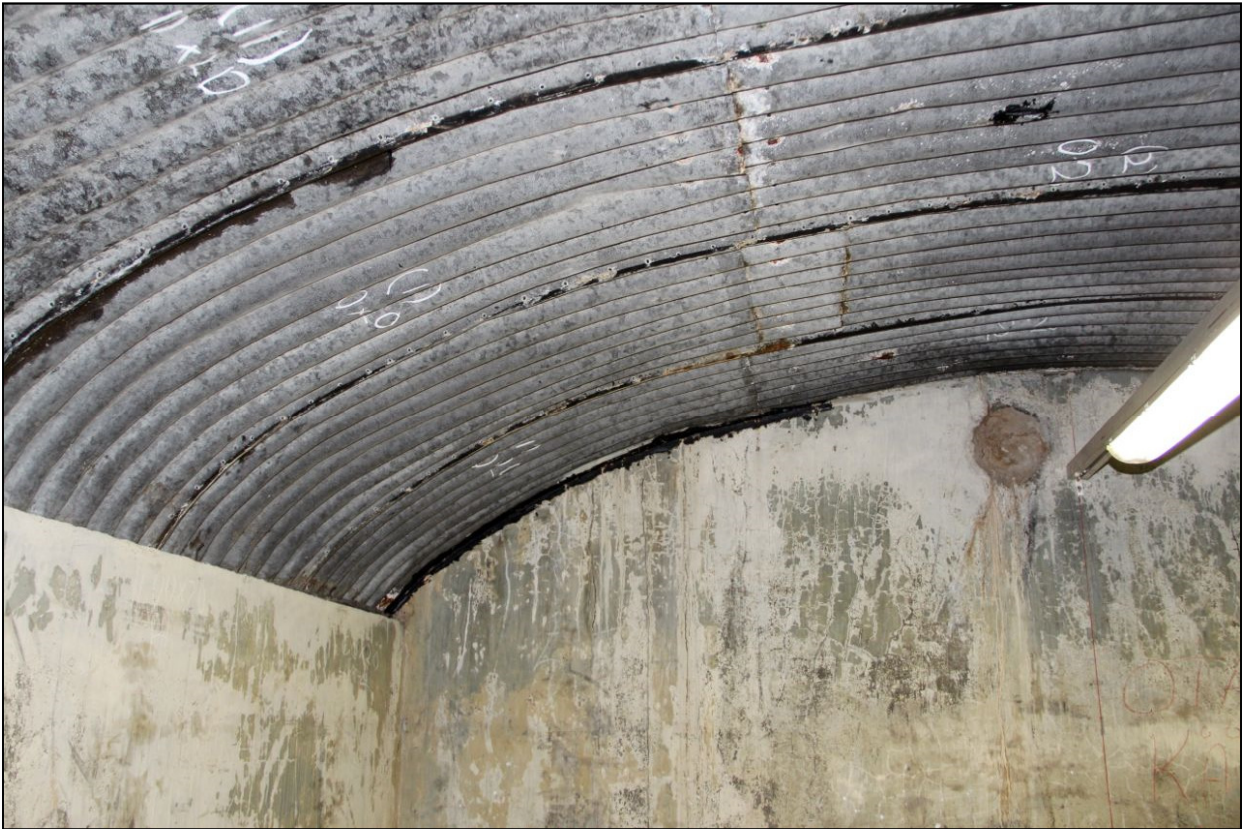
Kuva 18. Luolan G6 varastotilan aaltopeltikaton saumoja on tiivistetty piellä. Kuva: AKDG49189:21.
