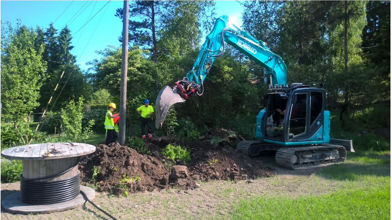
Kuva 9. Kaivutyö aloitettiin valvottavan osuuden eteläpäästä. Pellon ja omakotitalon kulmaukseen tehtiin monttu jakokaapille. Kuva: Petro Pesonen/ARKE (AKDG 5109:11).
