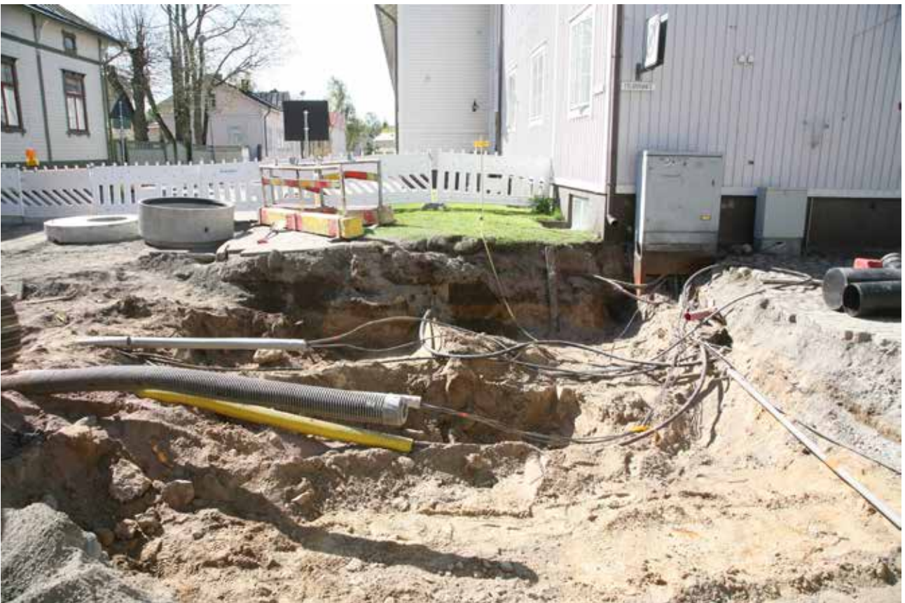
MuTu116012Dg_2. Alue 6. Alueen länsiosa, Kulmalankadun ja Eteläpitkätkadun risteys, eteläprofilissa pienellä alueella jäljellä koskemattomia kerroksia. 12.5.2016. Pohjoisesta. J. Haarala.
