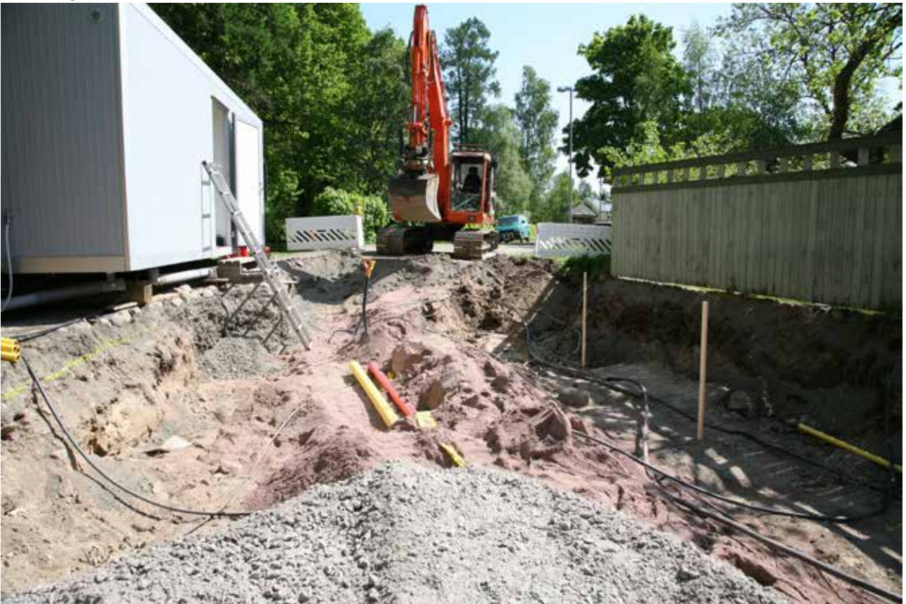
MuTu116012Dg_6. Alue 6. Yleiskuva kaivuuvaiheesta Turunkadulla kirkon lounaispuolella. Kulttuurikerrokset tuhoutuneet jo aiemmissa putkitöissä ja maansiirroissa. 1.6.2016. Luoteesta. J. Haarala.
