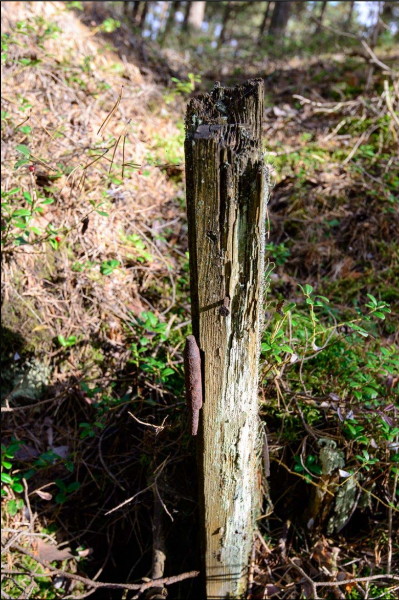
Kuva 13. Linnoitteen sisäänkäynnin ovenkarmin jäännökset ovat jääneet paikoilleen kohteessa Koverhar 28. Kuva: AKDG5032:1. Vesa Laulumaa.
