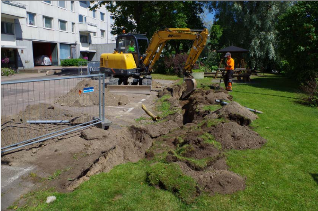
Kuva 5: Kaapeliojaa B kaivetaan asvaltoidun pihan ja nurmikentän välimaastoon. SW. Kuva: KyM/M. Kykyri.
