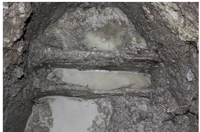
Kuva 8. Puinen salaojaputki koekuopassa 3, kuvattu lounaasta. AKDG 5210:7
