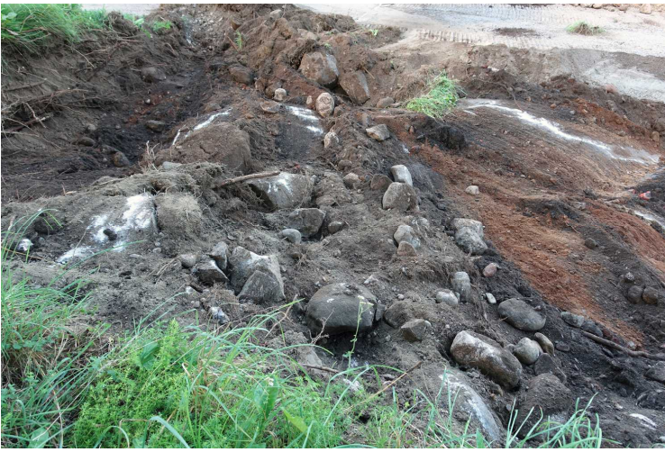
Kuva 125. Parkkipaikka. Alueen eteläosa. Kuvassa kallion ja moreenin päällä on vielä tumman multakerroksen päällä ollutta kivitäytettä. Kuvaussuunta SW. 2.8.2016.
