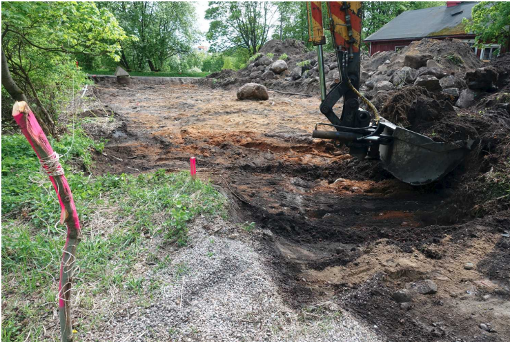
Kuva 63. Rakennus. Edellinen tilanne. Muu osa rakennusalueesta on kaavittu moreeniin saakka. Kuvaussuunta SSW. 17.5.2016.
