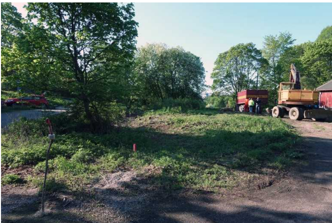
Rakennus. Alue koneellisen kaavinnan alkaessa. Suurin osa puista on kaadettu. Kuvaussuunta SE. 17.5.2016.
