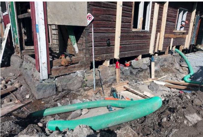
Vanha rakennus. Rakennuksen kaakkoiskulma. Itäseinän huonokuntoinen kivijalka on moreenin päällä. Ulkopuolella näkyy kaivannossa kallio. Kuvaussuunta NW. 10.6.2016.
