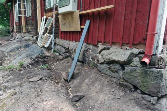
Vanha rakennus. Rakennuksen länsisivun eteläosa. Muurattu kivijalka on suurimmaksi osaksi kallion päällä. Rakennuksen lounaisnurkan edestä on poistettu kallion päällä ollutta multaa. Taaempänä näkyvä kallio on ollut esillä. Kuvaussuunta N. 10.6.2016.
