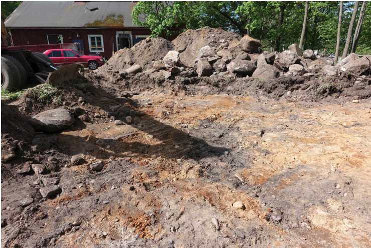
Kuva 51. Rakennus. Edellisten kuvien alue moreeniin saakka kaivettuna. Edessä on tummempi alue ulkorakennuksen kivijalan kohdalla. Kuvaussuunta WSW. 17.5.2016.
