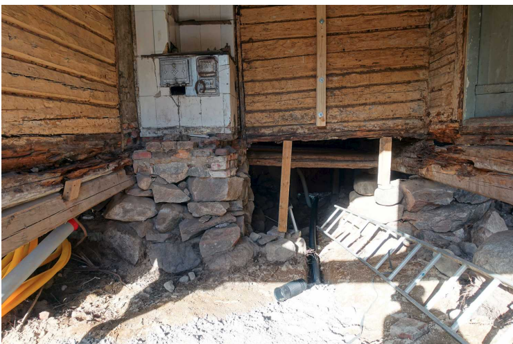
Kuva 189. Vanha rakennus. Rakennuksen koillinen huone. Tilassa ei näkynyt kalliota kuin koilliskulmassa kivijalan kohdalla. Kuvaussuunta WSW. 10.6.2016.
