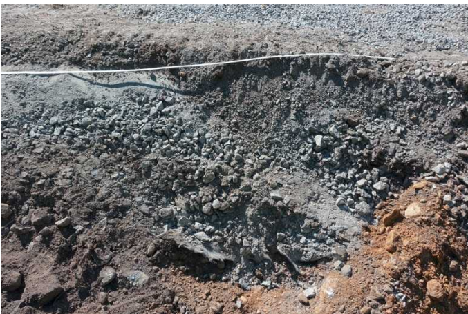
Parkkipaikka. Alueen länsireunassa vanhan tien/parkkipaikan soran alla oli syvällä eristekangas moreenin päällä. Kuvaussuunta WSW. 2.8.2016.
