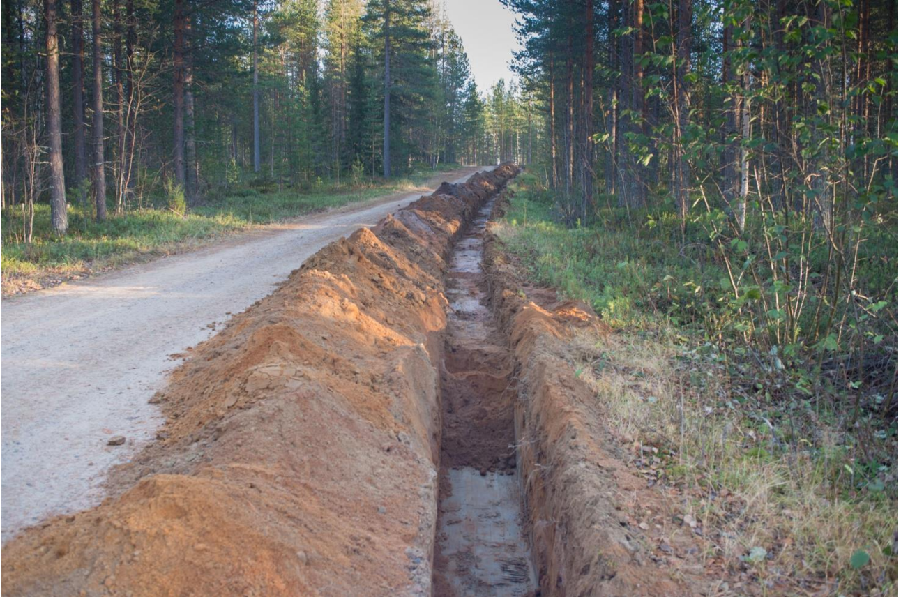
SKDG 201610:34 Alueen 5 ennen tasokaivauksen aloittamista. Alue 5 sijaitsee kaivinkoneella kaivetussa ojassa kuvan keskivaiheilla. Kuvattu kohti kaakkoa.
