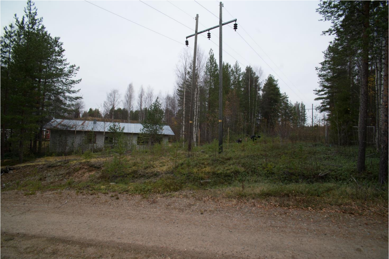
SKDG 201610:4 Alue 2 ennen kaivutöiden aloittamista. Sähkölinjalle rakennettavan pääteen pylväiden paikat sijaitsevat hieman kuvan keskikohdan oikealla puolella mustiin vaatteisiin pukeutuneiden Inga Niemisen ja Esa Haatajan kohdalla. Uusien haruksien paikat sijaitsevat suurin piirtein kuvassa näkyvien kahden sähköpylvään kohdalla. Taustalla erottuu voimalan huoltorakennus. Kuvattu kohti pohjoista.
