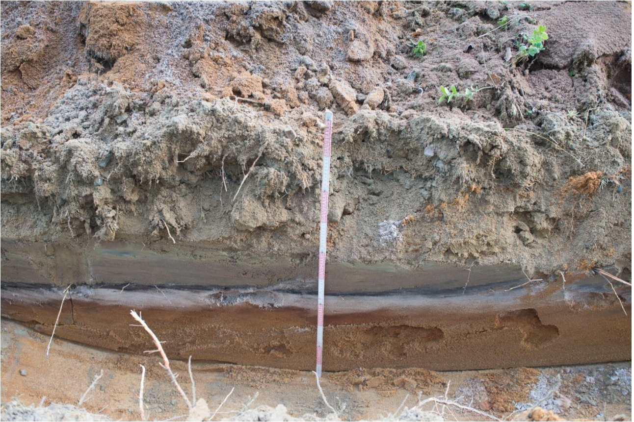
SKDG 201610:50 Tyypillinen profiili valvotussa kaivannossa. Päälimmäisenä 10- 20 cm harmaa tiekerros, jonka alla on pääasiassa ehjänä säilynyt vanha maanpinta.
