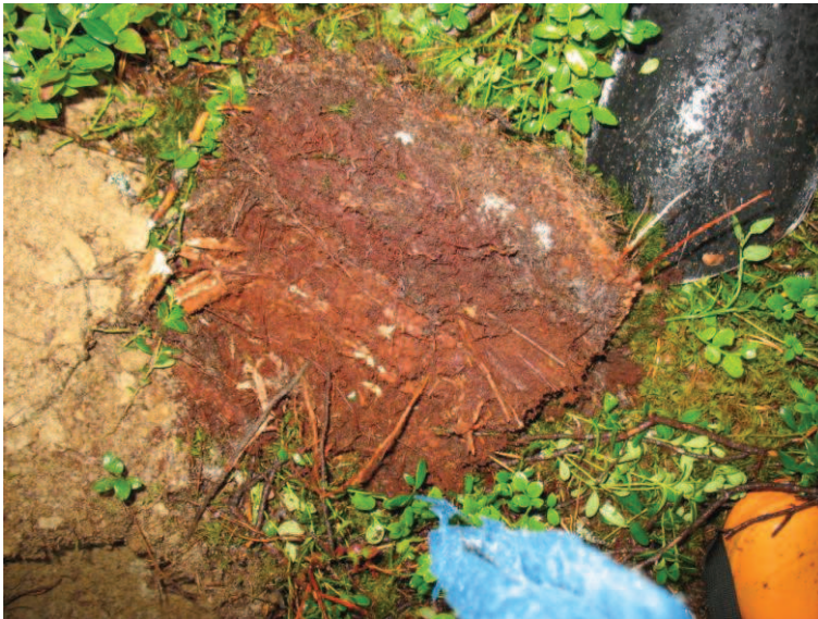
Kuva 152: Rakennuksen pohjaan tehty koekuoppa paljasti sammaleen alta lautalattian.
