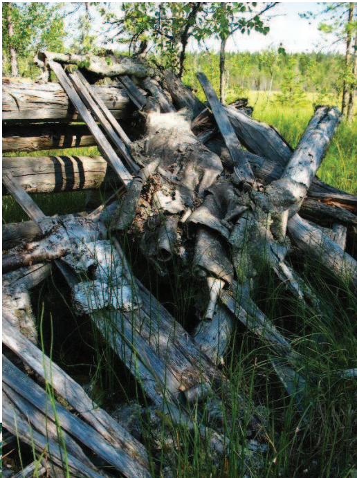
Kuva 261: Vasemmalla olevassa kuvassa ladon romahtaneita kattorakenteita. Kate on tehty koivuntuohesta.
