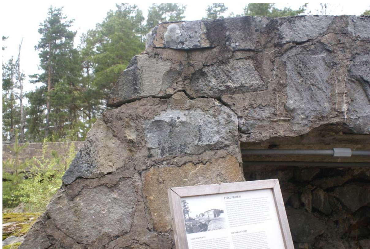
Kuva 1. Vaakasuora halkeama pikkupatterin kuvussa.
