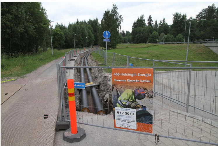
Kuva 31. Putkikaivantoa lounaaseen päin kuvattuna. Oikealla Vanha Tuusulantie. Telekaapelit menevät poikki kaivannon. Kuvaussuunta SSW. Kuva Heini Hämäläinen/HKM 25.6.2013.
