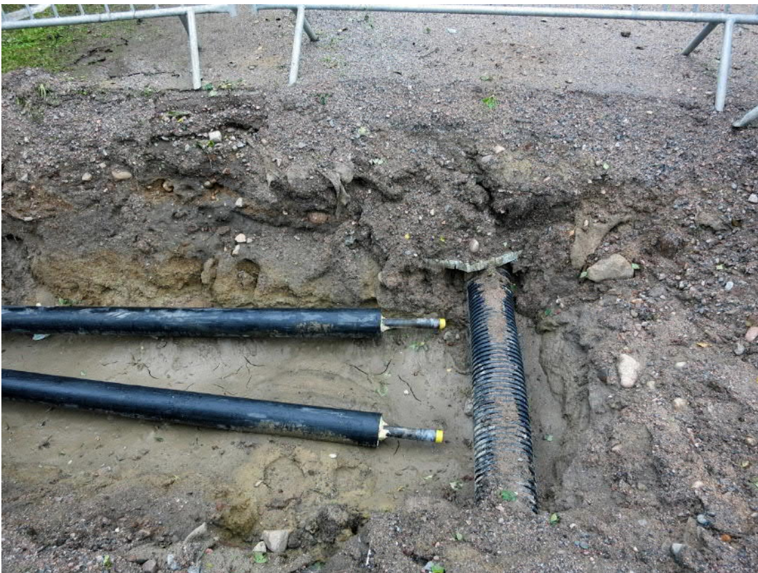
Kuva 33. Kaisanmäenkuja, rakennus 39. Pitkittäin kujan alla oli aluelämpökeskuksen vanhat putket, joihin uudet putket liitettiin. Kuvaussuunta WNW. Kuva Markku Heikkinen/HKM 29.8.2014.
