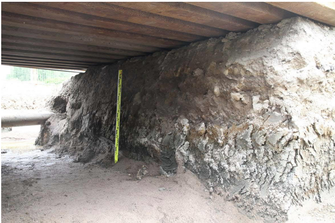
Kuva 8. Kuten yllä. Tien poikki menevän kaivannon itäprofiilia koilliseen päin kuvattuna. Vasemmalla tien pohjoislaitaa kulkeva putki. Kuvaussuunta NE. Kuva Heini Hämäläinen/HKM 25.6.2013.
