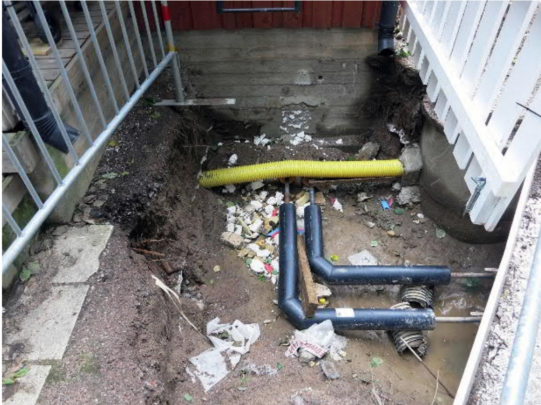
Kuva 44. Kaisanmäenkuja, rakennus 16. Lähikuva putkien sisäänmenokohdasta. Vanhat putket ovat tulleet samaan kohtaan tehtyään mutkan rakennuksen itäpuolelta. Kuvaussuunta NW. Kuva Markku Heikkinen/HKM 29.8.2014.
