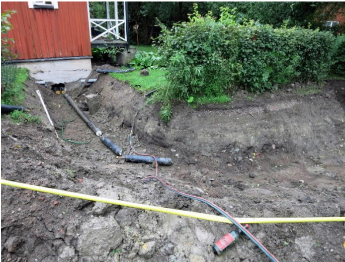
Kuva 42. Kaisanmäenkuja, rakennus 16. Uusien putkien linja meni rakennuksen koillisnurkkaan. Kuvaussuunta WNW. Kuva Markku Heikkinen/HKM 29.8.2014.
