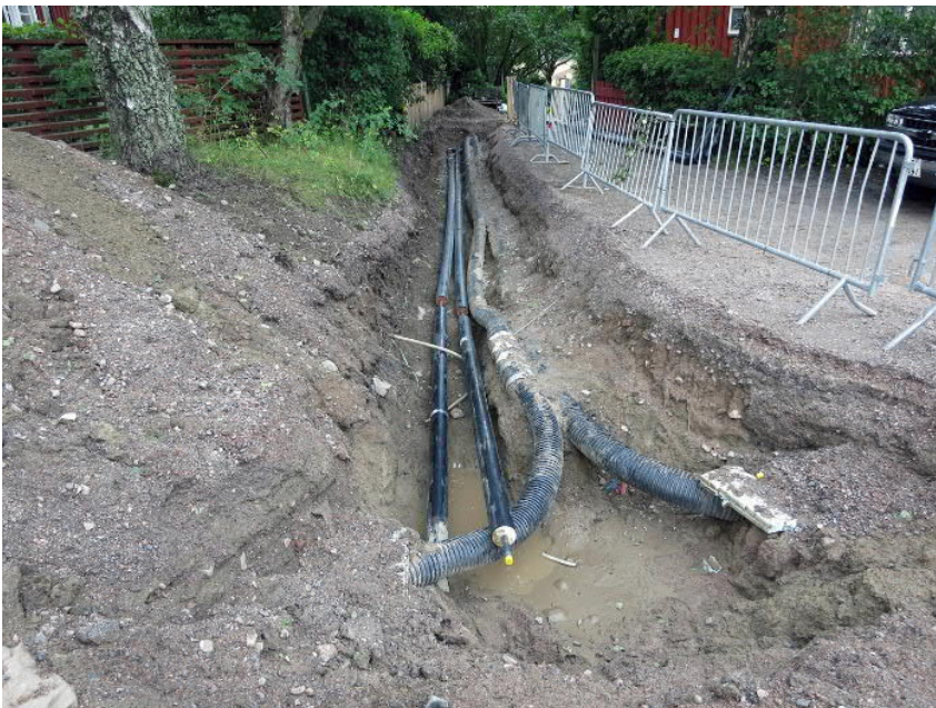
Kuva 35. Kaisanmäenkuja, rakennus 40. Vanhat ja uudet kaukolämpöputket samassa kaivannossa pihatien alla. Kuvaussuunta SSW. Kuva Markku Heikkinen/HKM 29.8.2014.
