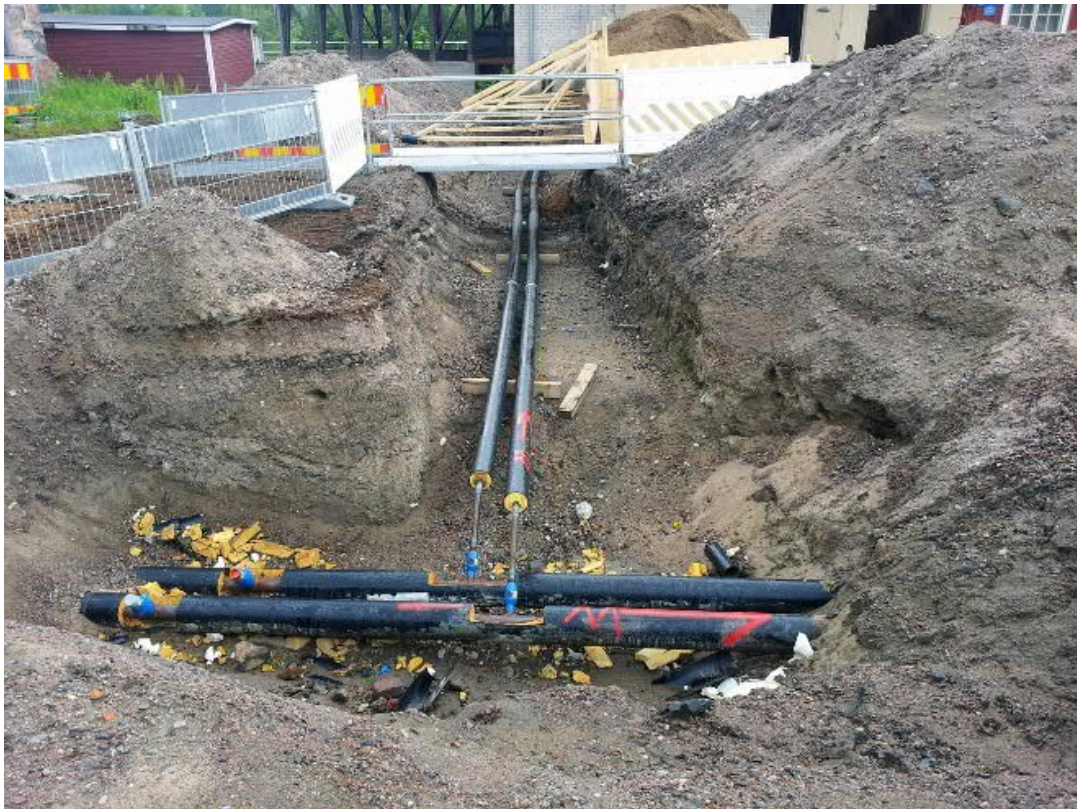
Kuva 45. Tallit. Uudet putket laitettiin menemään etualan vanhoista putkista suoraan aukion itäpuolisen tallin (rakennus 21) pohjoispäähän. Kuvaussuunta ENE. Kuva Markku Heikkinen/HKM 24.6.2014.
