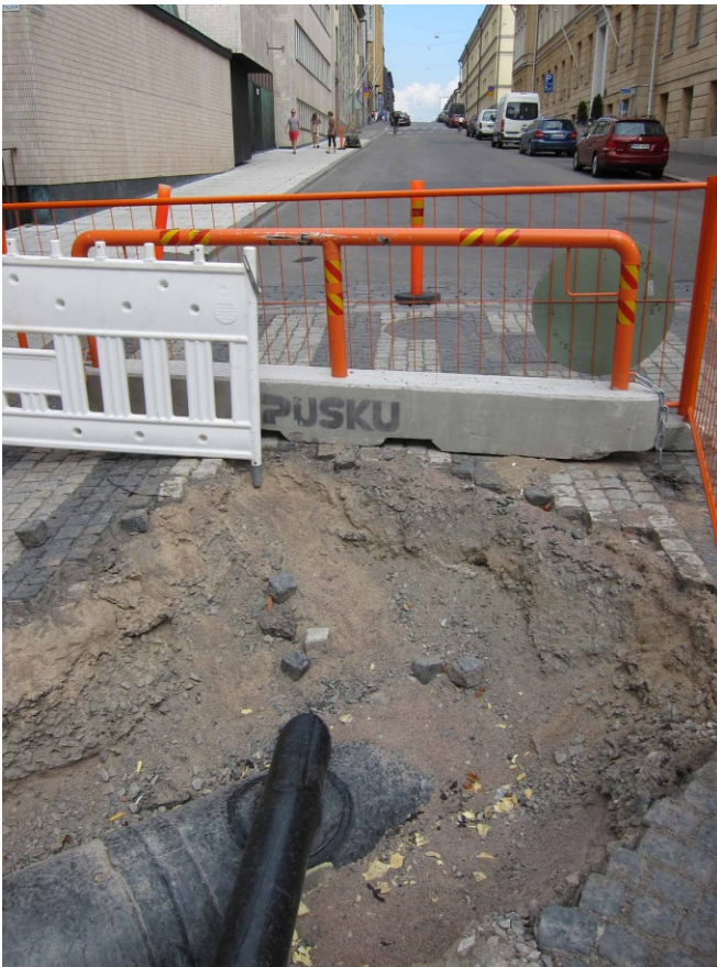
Kuva 3. Putkikaivannon pohjoispää pohjoiseen kuvattuna eli Fabianinkatua näkyvissä. Kuvassa näkyy paksu aiemmin asennettu putki, johon uusi ohut putki liitettiin. Kaivannossa on täyttömaata. Kuva Heini Hämäläinen/HKM 30.7.2014.
