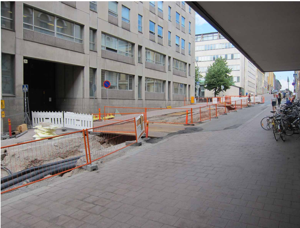
Kuva 1. Kaivantoa Fabianinkadulla pohjois-luoteeseen kuvattuna. Taustalla silloinen Helsingin yliopiston hallintorakennus, nykyinen Tiedekulma. Kaukolämpö- ja kaukojäähdytysputkien kaivanto kulki ajo-kaistan keskivaiheilla. Risteyksen suojatien ja porttikongin kohdalle on asetettu metalliset ajosillat. Kuva Heini Hämäläinen/HKM 30.7.2014.
