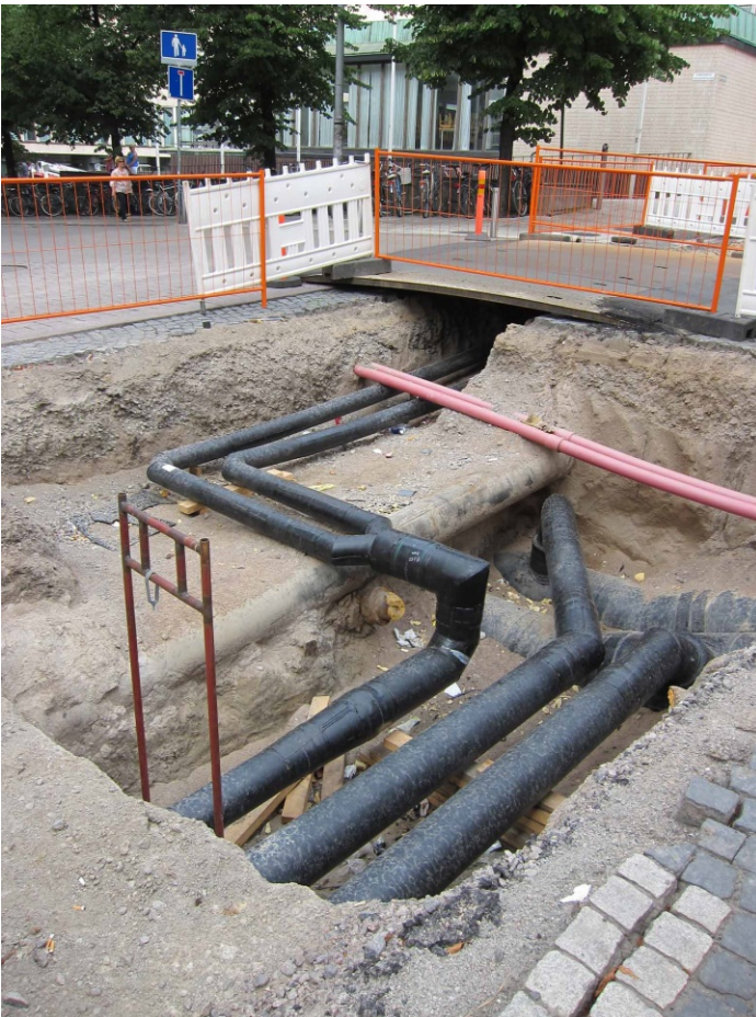
Kuva 5. Putkikaivannon pohjoisosaa risteyksessä, taustalla Porthania. Lukuisia aiemmin asennettuja putkia kulkee ristiin rastiin eri syvyyksillä. Mustat ohuemmat putket ovat nyt asennettuja uusia kaukolämpö- ja kaukojäähdytysputkia. Kuva Heini Hämäläinen/HKM 30.7.2014.
