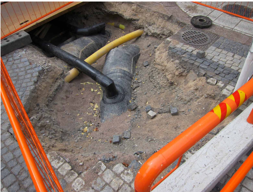
Kuva 4. Kuten yllä, mutta kuvaussuunta lounaaseen. Keltaisissa putkissa kulkee tietoliikennekaapelit. Kuva Heini Hämäläinen/HKM 30.7.2014.
