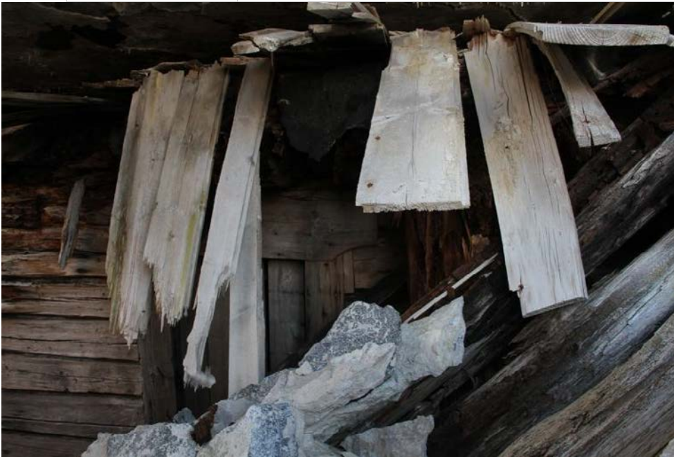
Romahtaneita lohkareita ja kattolautoja, taustalla ovi.
