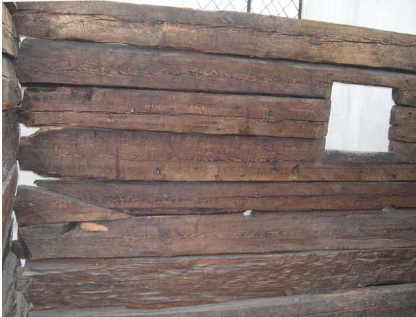
Alapinnalta hiiltynyt hirsi on kuvassa 5. ylhäältä. Sen alla on kehikin vanhin ajoitettu hirsi ja näiden kahden hirren välissä on toisiinsa sopivat pienet kolot. Kuva: Niina Uusi-Seppä
