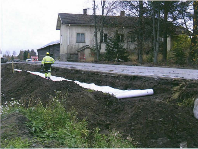
Kuva 4. A–D-v-alueille levitetään suodatinkangasta. Tien toisella puolella Sapalan koillinen päärakennus ja Sapalan vanhaa pihaa, jota istutetut puut reunustavat. Kuvaussuunta itäkoilliseen. Kuvaaja: Sami Raninen. KYY 130: 38.
