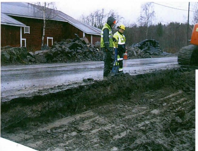
Kuva 35. Anian rantatien itäiseen pengerluiskaan avattua kaivantoa Juoksianojan eteläpuolella. Taustalla vanha ulkorakennus (Kierikan riihi?), jonka edustalla sijainnut kalliopaljastuma on räjäytetty. Ulkorakennuksen takana sijaitsee Pyhäjärven Kotolahti. Taustalla häämöttää Kotolahden pohjoisrannan rantametsikköä. Kuvaussuunta luoteeseen. Kuvaaja: Sami Raninen. KYY 130: 87.
