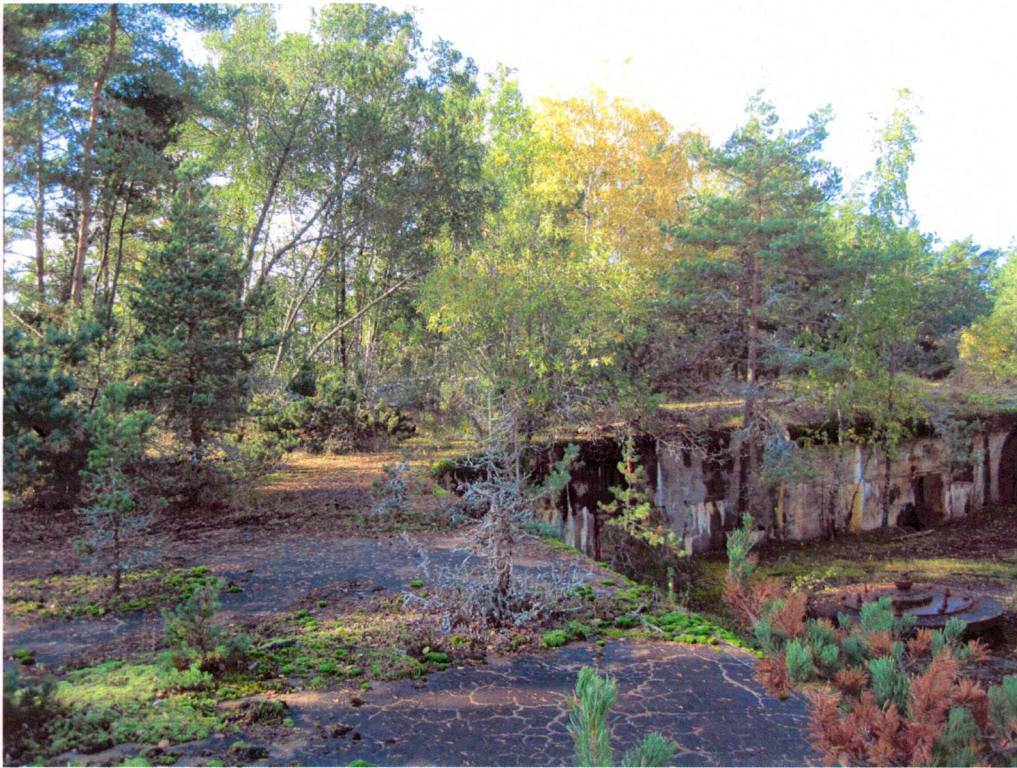
Kuva 8. Tykkipatterin päällystä. Puut kasvavat suoraan betonissa ja vaurioittavat betonipintaa, mistä vesi- ja pakkaseroosio jatkavat rakenteen tuhoamista juuriston lisäksi. Kuvattu idästä.
