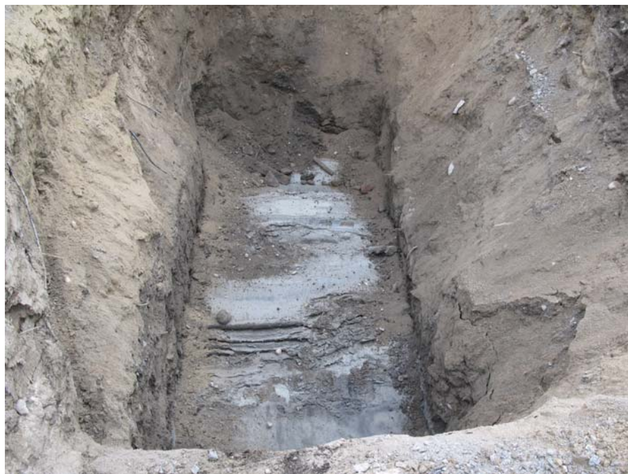
Kuva 17. Koealue A pohjasaveen (ASY8) saakka kaivettuna, seinämät romahtaneet kaivauksen alkuvaiheessa. Kuvaussuunta pohjoiseen. Digitaalikuva MV/RHO.
