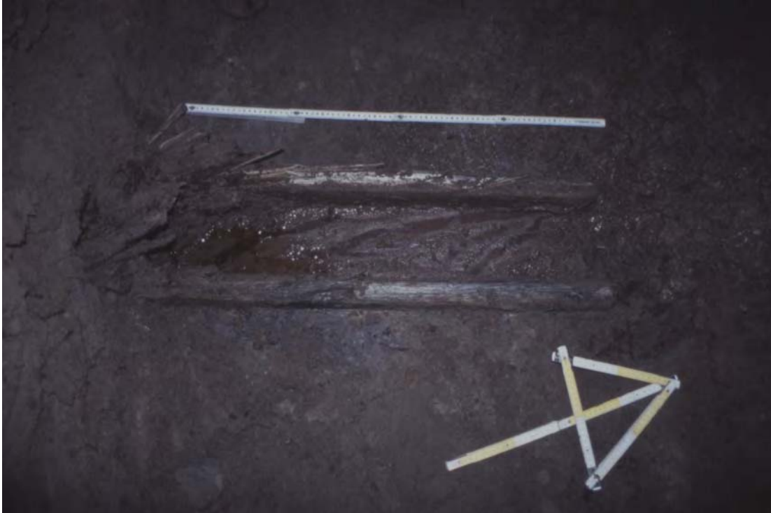
Kuva 37. Rakenne R6 eli puinen koteloviemäri kuvattuna ylhäältä. Kansilauta puuttuu rakenteesta. Dia 125697, MV/RHOA. Kuvaaja: Marika Hyttinen.
