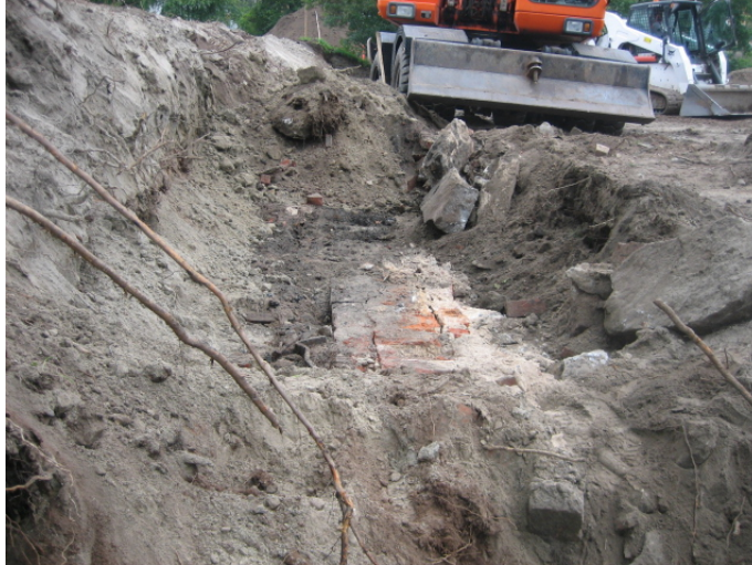
Kuva 1. Tukimuurikaivannosta paljastunut tiilirakenne kuvattuna kaakkoon. Kuvaaja: Petri Snellman, ISS Proko Infra Oy.
