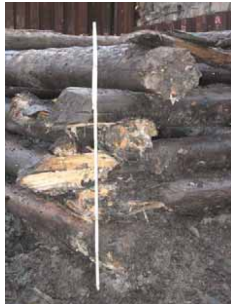
Kuva 47. Digitaalinen kuva nro 71. Nurkka e, rikkoutuneet hirsien päät. Kuvattu luoteeseen. Kuvaaja: T. Taipaleenmäki, MV/RHO.
