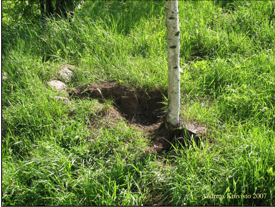
Kuva 1. Kylpylärakennuksen perustuksiin oli vuosien 2006 ja 2007 tutkimusten välissä tehty luvattomia kaivantoja.
