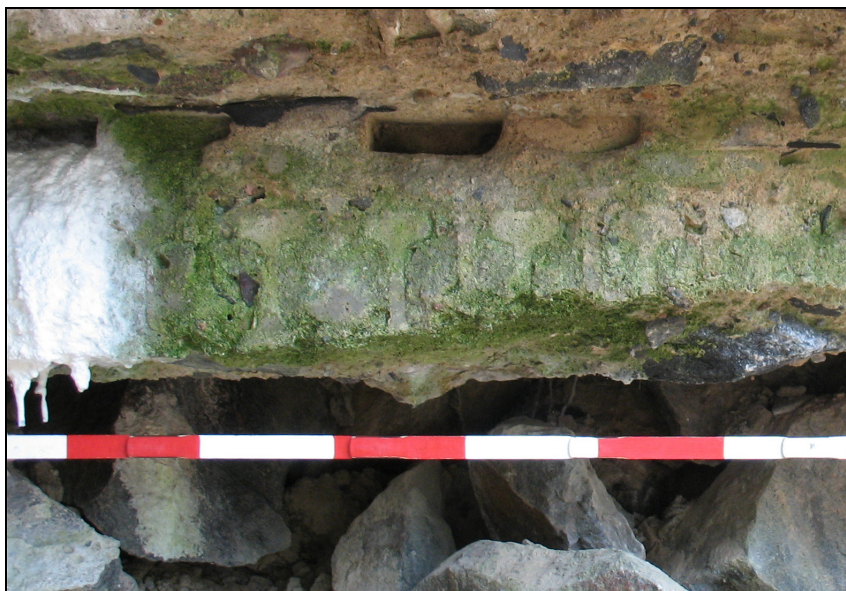
Kuva 11 Katon tukirakenteina olleiden teräskiskojen ja lautojen jälkiä betonissa. Vasemmalla laudanjälkien yläpuolella on katossa kiinni kappale tervahuopaa. Kuva: John Lagerstedt, 2008.
