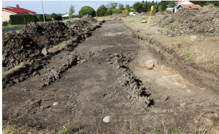
Kuva 6. Alue 2B pintaturpeen poiston jälkeen. Kuvan oikeassa laidassa on kaivinkoneella tehty syvennys, josta tarkistettiin maakerrosten paksuus. Kuva on otettu länteen. R. Väisänen
