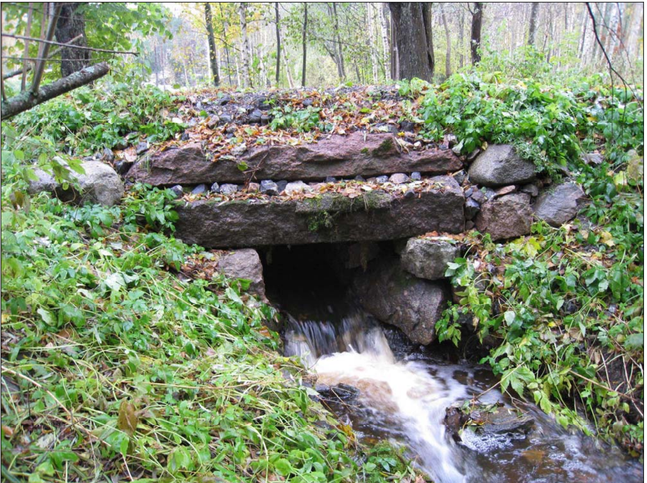
Kuva 15. Nikuvikenin luoteisosaan virtaavan puron siltarumpu, joka alittaa Nikubyntien. Etelästä. Kuva: W. Perttola/Museovirasto
