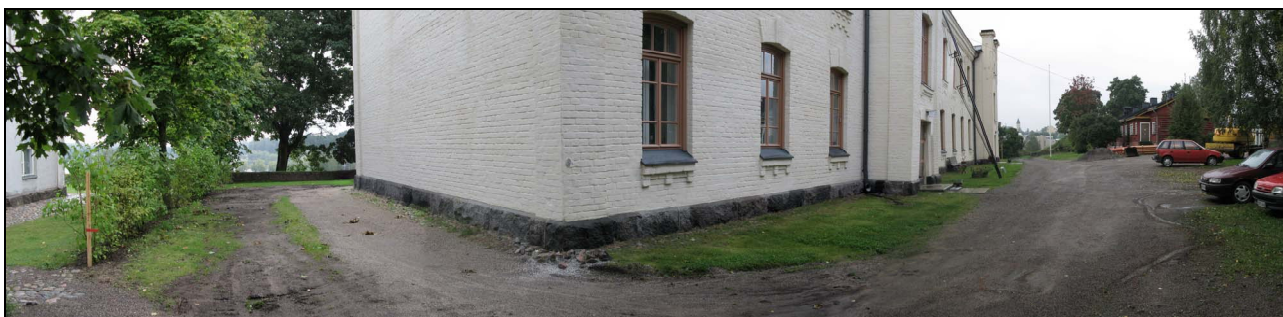
Kuva 7. Panoraama rakennusten 1 ja 2 sekä kirkon välisestä alueesta ennen töiden aloittamista. Kuvan vasemmassa laidassa pensasaidan oikealla puolella näkyvät aiemmat kaivamisen jäljet. Luoteesta. Kuva: W. Perttola/Museovirasto.
