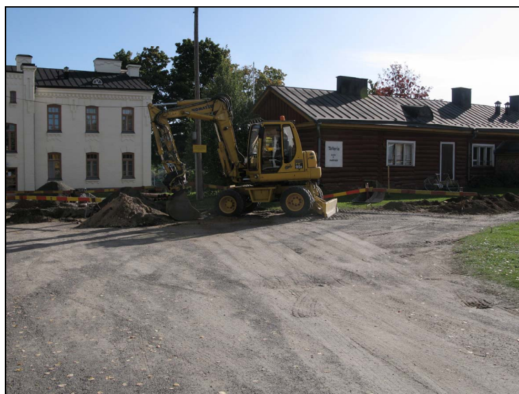
Kuva 6. Ilman valvontaa jäänyt osuus rakennuksen 4 luoteisnurkalla. Lännestä. Kuva: W. Perttola/Museovirasto.
