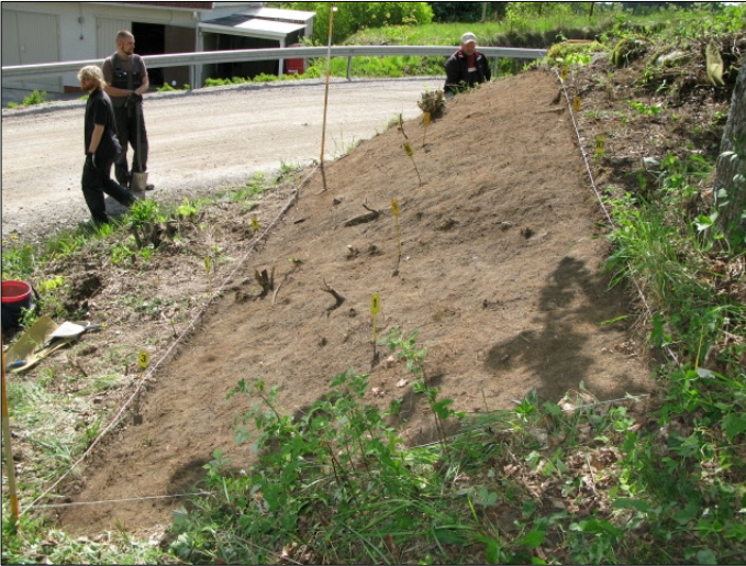
DG583:17 Alue 1, taso 1 Kuvassa kaivausten johtaja Esa Mikkola sekä kaivajat Stephan Schulz ja Lassi Närväinen kuvattu pohjoisesta kuvaaja: Riku Mönkkönen
