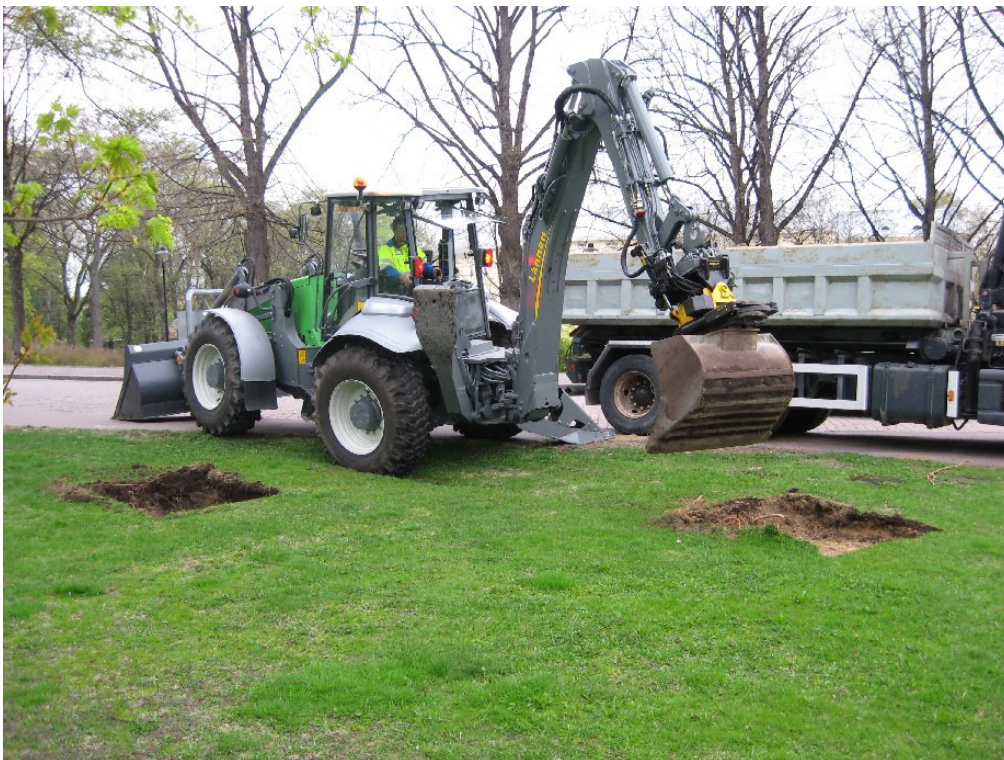
Kuva 5: Omenapuiden istutuskuopat kaivettiin lapiolla, mutta katsurat vaativat omenapuita laajemmat ja syvemmät istutuskuopat, jotka kaivettiin koneellisesti. Kuvassa kaivetaan kuoppia n:o 12 ja 13. E. Kuva KyM/M. Kykyri.
