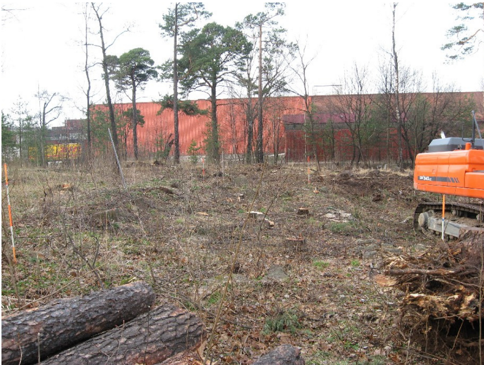
Kuva 8: Kiviperustus puiden kaadon jälkeen huhtikuun lopussa 2009 (NE). Rakennuksen ulkonurkat on merkitty maastoon oranssi-valkoisin linjaseipäin. Kuva KyM/M. Kykyri.
