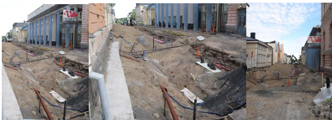
Kuvat 8-10. Tutkimusalueiden A ja B eteläpää ja kadun itäpuolen kaapeloinnit. Valveen julkisivusta n. 5 m levyinen kaistale jätettiin kaapeleiden takia kaivamatta. Digikuvat 126341:105, 107 ja 108.
