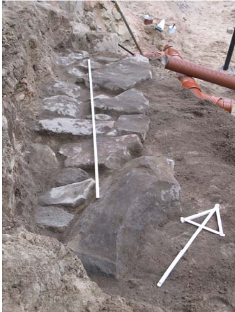
Kuva 11. Rakenne AR1a, kivijalka. Digikuva 126341:12.
