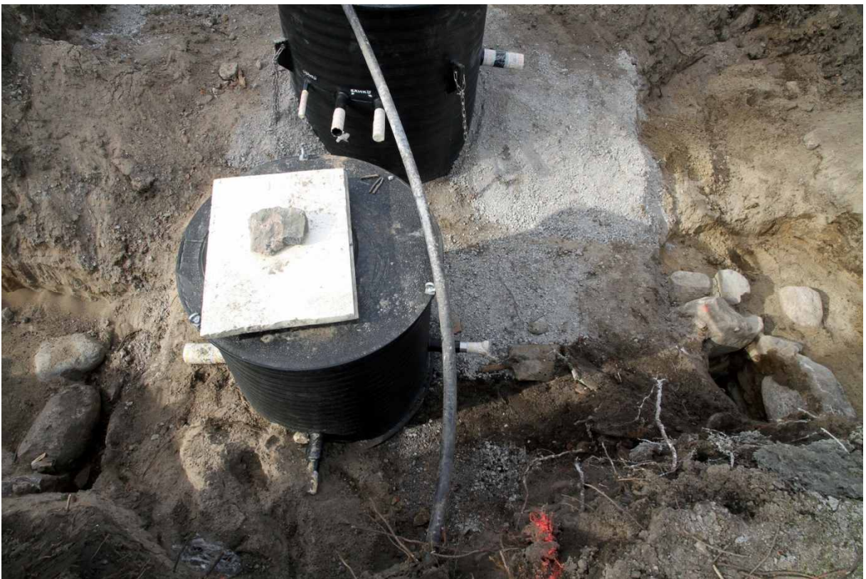
Kuva 95. Kellari. Sama tilanne. Kuva päältä. 3.5.2010. Kuvaussuunta: N.
