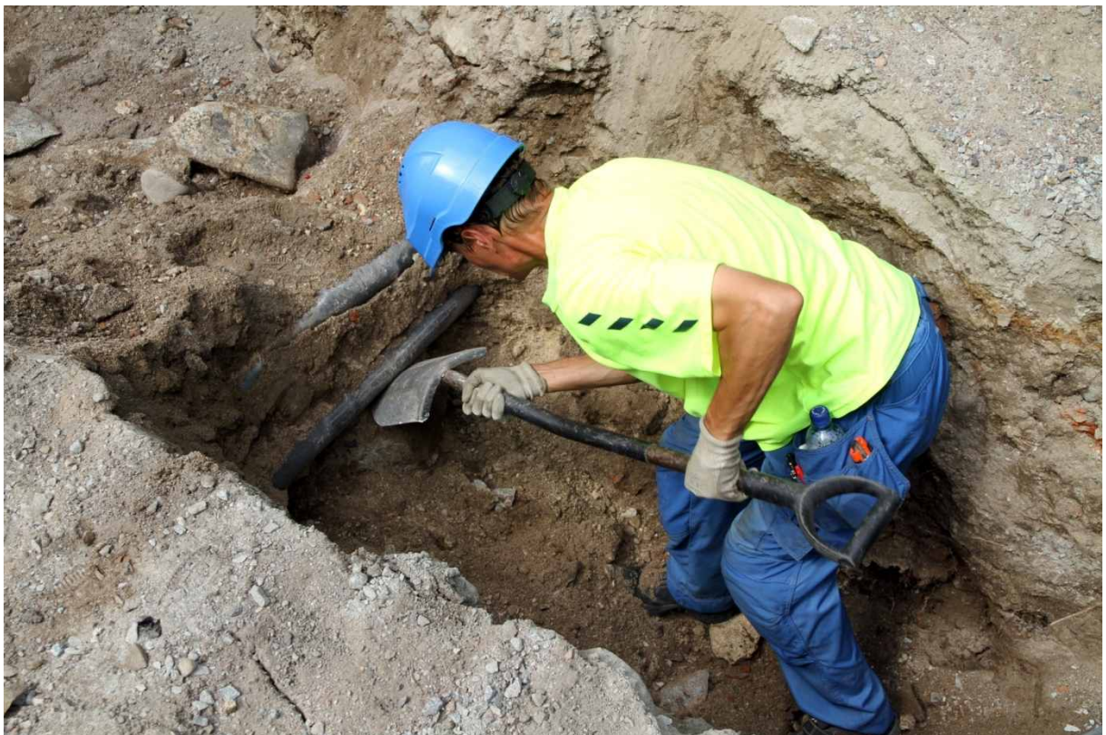
Kuva 101. Läntinen kaivanto, lisäosa. Muovisten suoja-putkien alitus piti suorittaa osittain lapiokaivuuna. 28.7.2010. Kuvaussuunta: NW.
