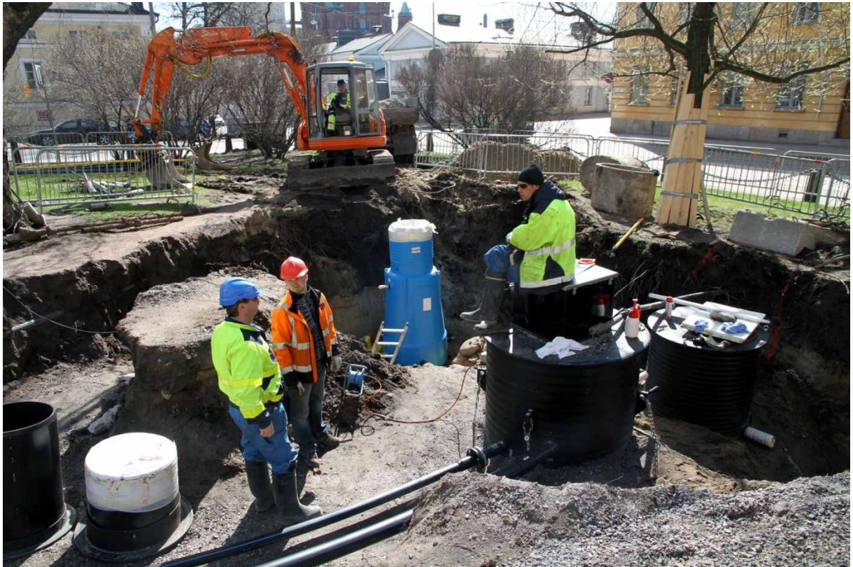
Kuva 98. Suihkualtaan eteläpuoli ja Kellari. Suurin osa kaivoista ja putkista on asennettu. Kuvassa on myös työmaan Staran työntekijät. 5.5.2010. Kuvaussuunta: SE.
