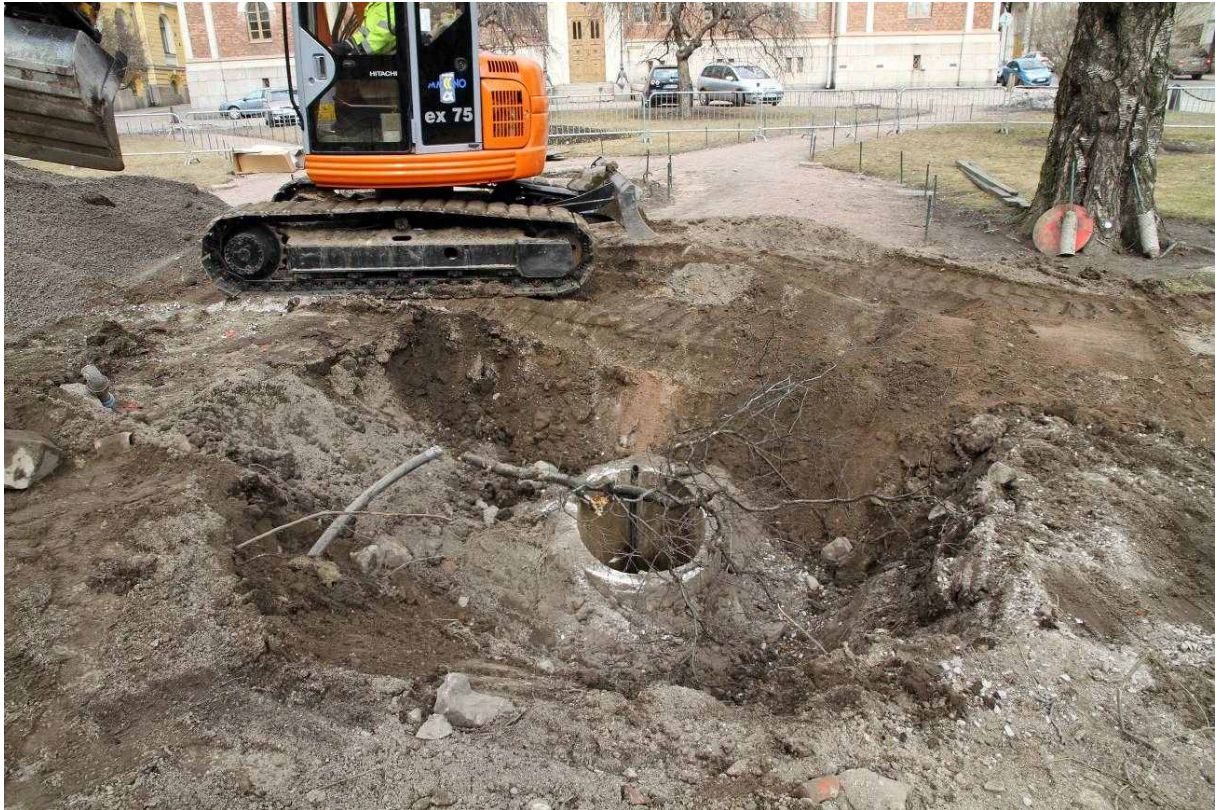
Kuva 3. Suihkualtaan eteläpuoli. Suihkualtaaseen liittyvä vanha betonikaivo on kaivettu esiin altaan eteläpuolelta. Itse suihkuallas sijaitsee kaivinkoneen takana. 15.4.2010. Kuvaussuunta: N.
