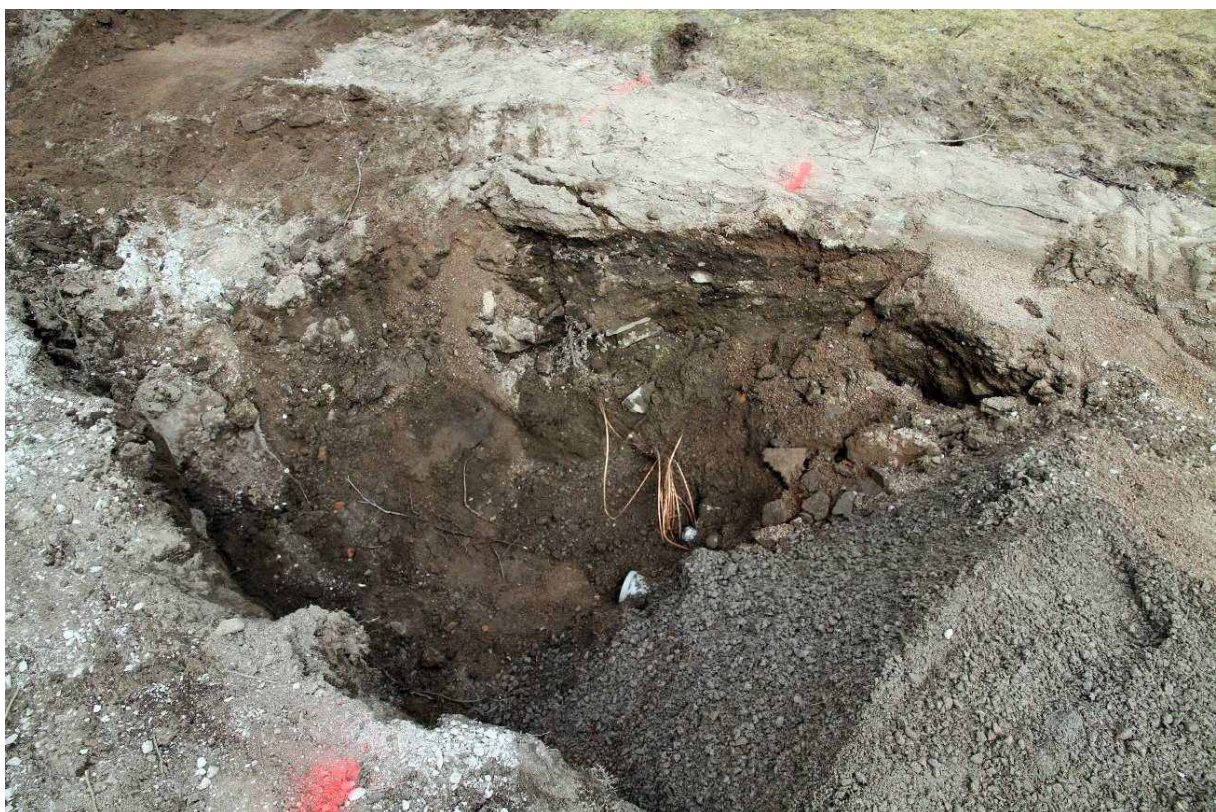
Kuva 2. Itäinen kaivanto. Kaivannon pohjoispään kuvaushetkellä avoimena ollut osuus. Pohjalla näkyy uudet muoviset suojarahat. 15.4.2010. Kuvaussuunta: N.
