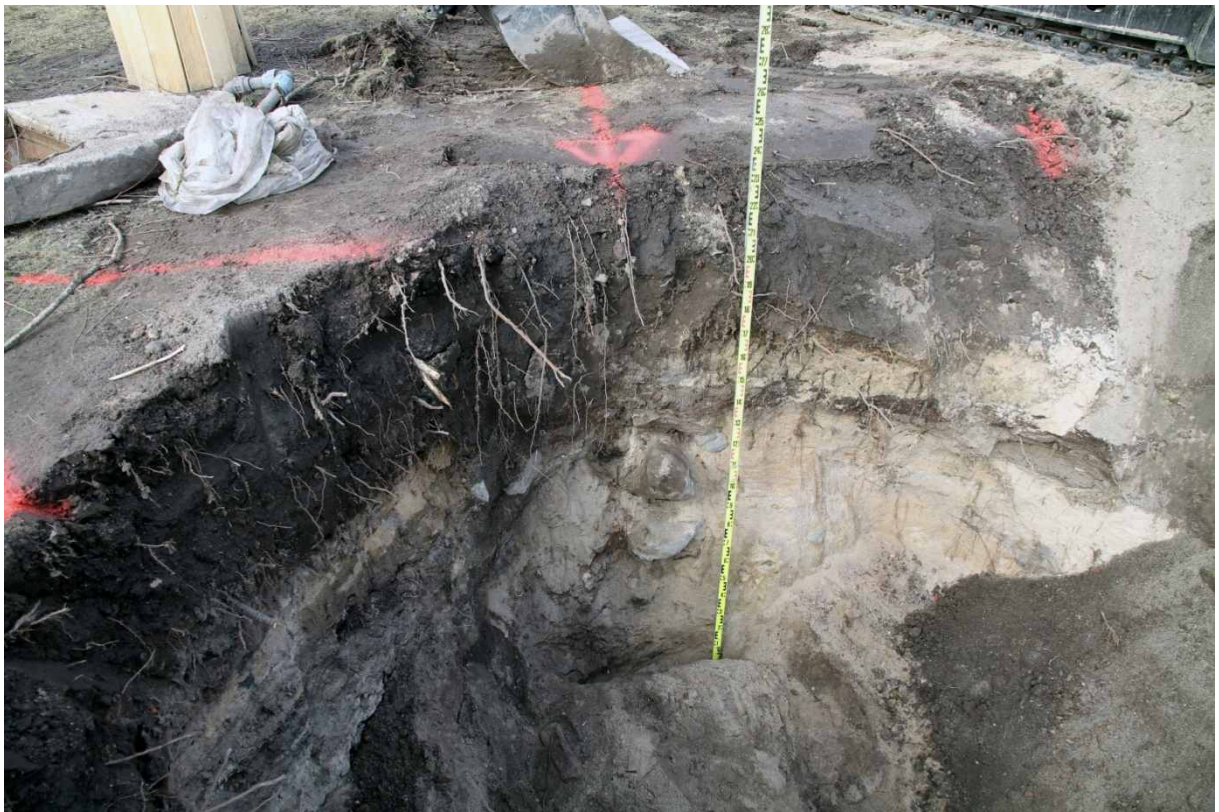
Kuva 12. Kellari. Kuopan lounaisosa. Kuvan keskellä latan vasemmalla puolella näkyy profiilin puolivälissä kolme kellarin pohjoisseinän kiveä. 19.4.2010. Kuvaussuunta: W.
