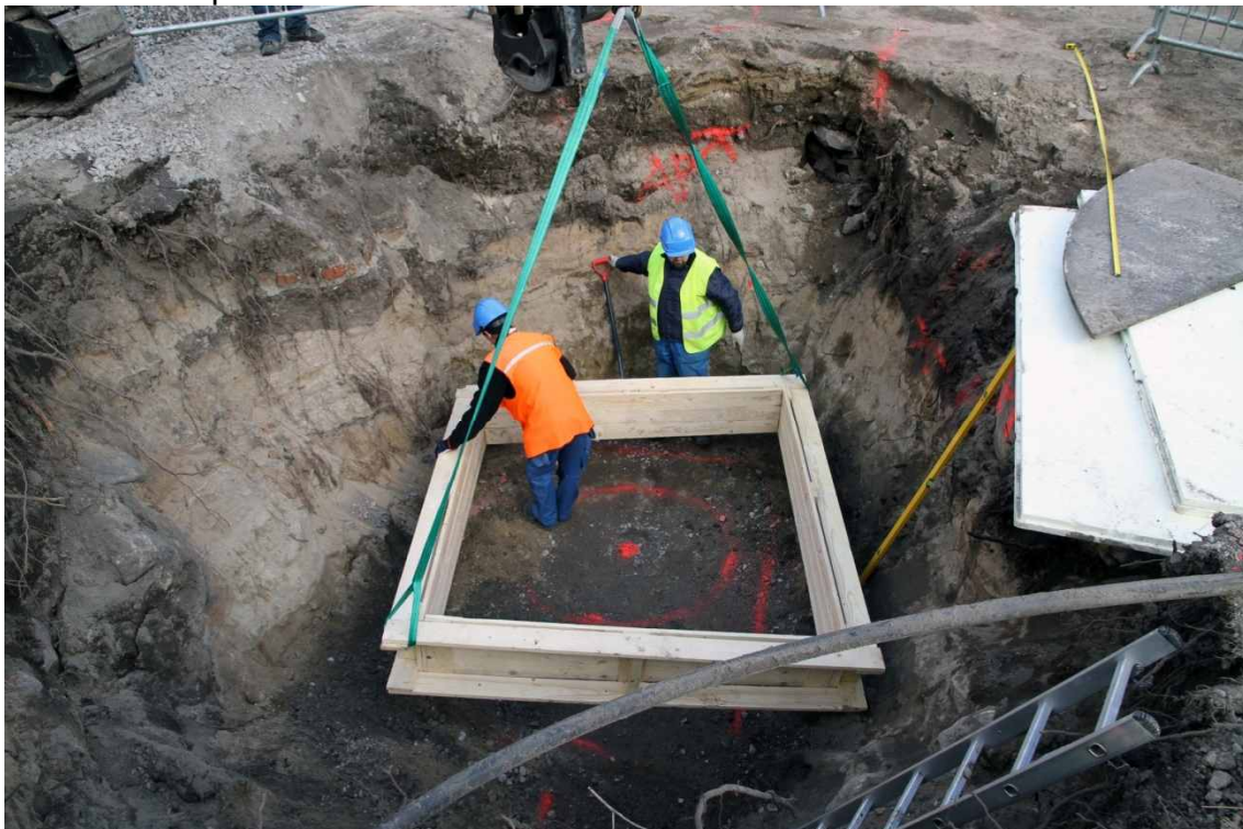
Kuva 22. Kellari ja Suihkualtaan eteläpuoli. Pumppaamon pohjan betonivalun laudoituskehikko asennetaan paikoilleen vielä lisää laajennettuun kuoppaan. 21.4.2010. Kuvaussuunta: N.
