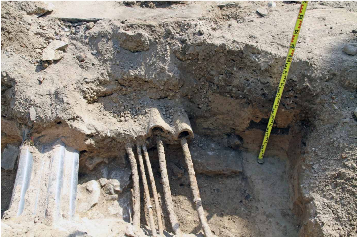
Kuva 106. Läntinen kaivanto, lisäosa. Muoviputkien kohdalla ja länsipuolella rakennuksen kivijalka on poistettu niitä tehtäessä. 28.7.2010. Kuvaussuunta: S.
