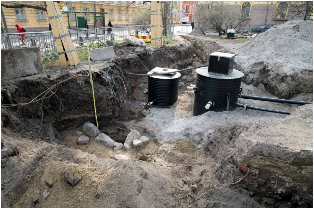
Kuva 92. Kellari. Yleiskuva kellarin eri osista rakennustöiden loppuvaiheessa. Kellarin koilliskulma näkyy latan edessä ja länsiseinä pumppaamon ja vesipostikaivon välissä. 3.5.2010. Kuvaussuunta: SW.
