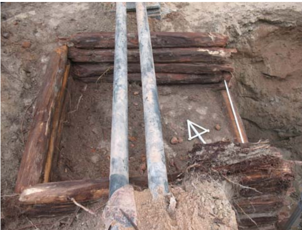
Digikuva 217919:33. Kaivo ja päältä kulkevat kaukolämpöputket. Kuvattu koilliseen.
