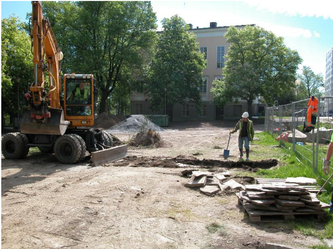
Kuva 1. Koekaivaus käynnistyi 3.6.2010 koeojan avaamisella. Kuvan oikeassa alakulmassa on lastauslavan päälle kasattu poistettua pihakiveystä. Taustalla kirjastotalo. Kuva: 3.6.2010.
