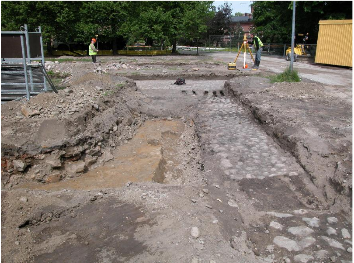
Kuva 10. Mittausdokumentaatio käynnissä Kirjastonpuiston työmaalla. Kuvattu alueen F eteläpuolelta kohti pohjoista. Koneen takana Teemu Tiainen, prisma-auvan pitää pystyssä Tuukka Kumpulainen. 18.6.2010, Kalle Luoto.
