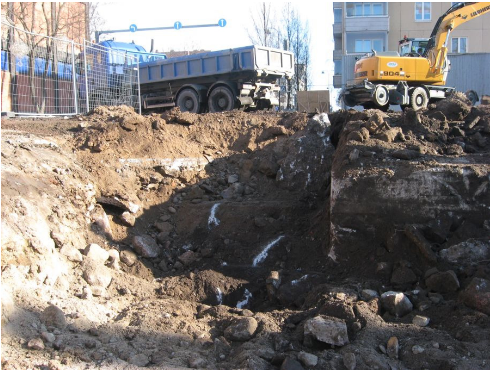
Kuva 22: Autohallin betoniperustuksen pohjoisnurkka oli rakennettu suoraan kivillä täytetyn kanavan päälle. NW. Kuva KyM/M. Kykyri.
