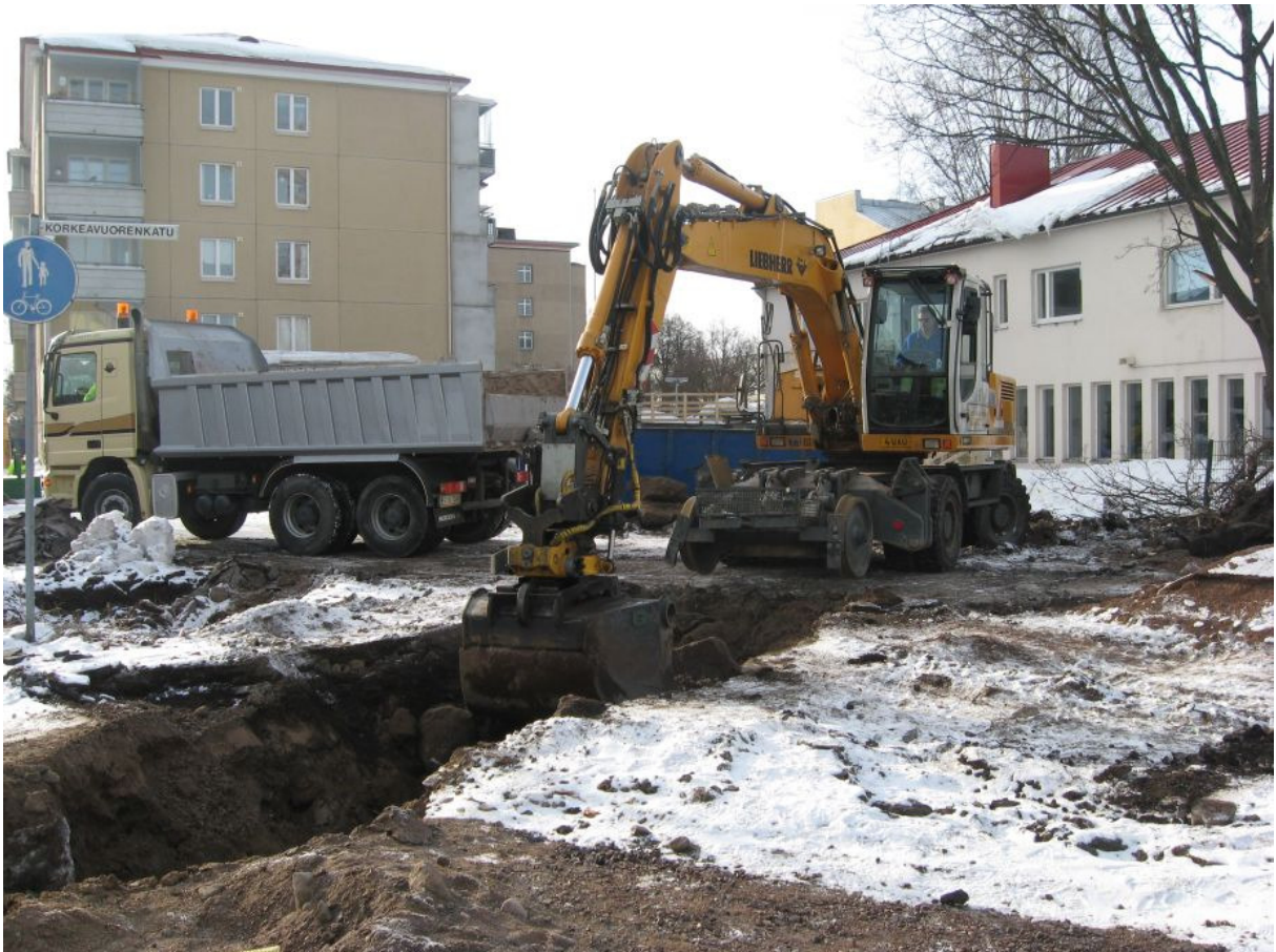
Kuva 6: Koeoja kaivettiin Korkeavuorenkadun ja Koulukadun kulmuksesta lähtien aina taustalla näkyvän Laulumiesten talon edustalle asti. N. Kuva KyM/M. Kykyri.
