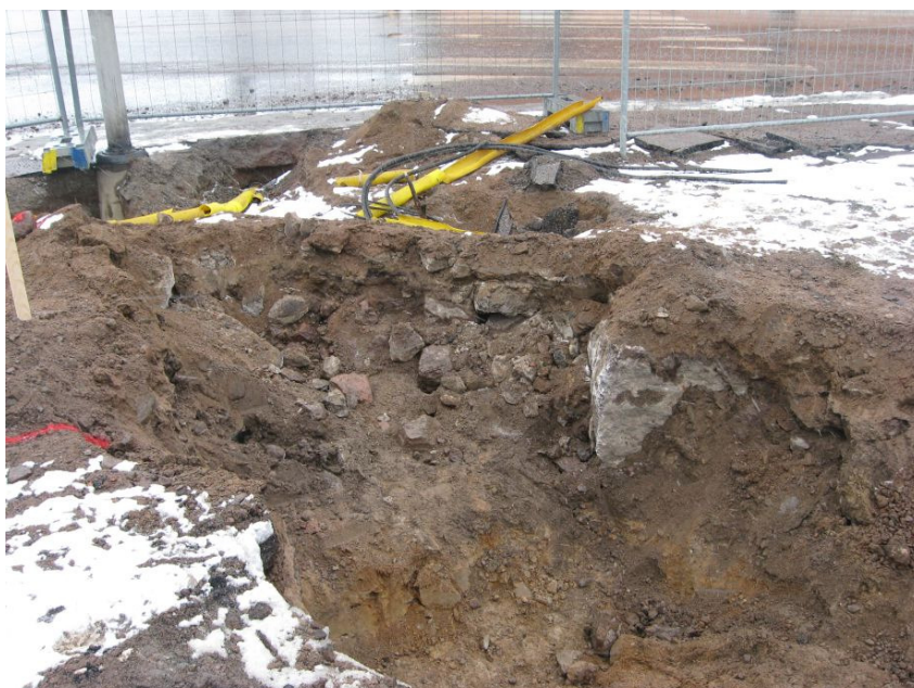
Kuva 13: 1930-luvun asuinrakennuksen kivijalan jäännöksiä Koulukadun reunassa. W.
