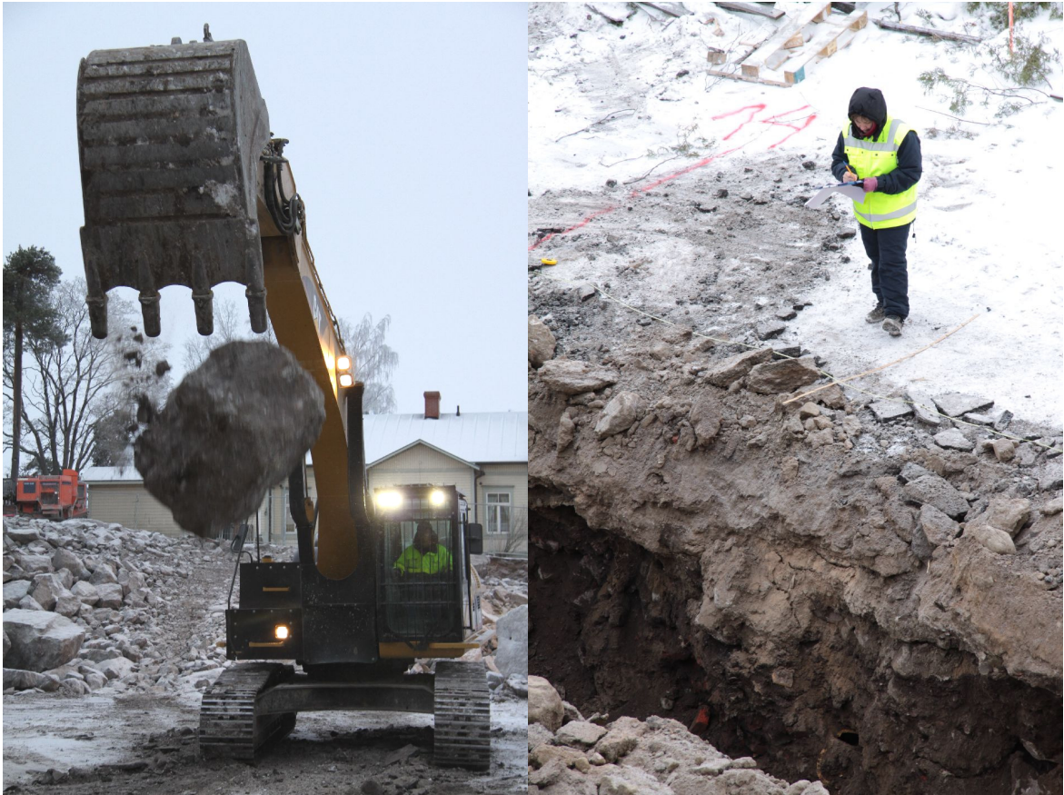
Kuvat 5-6: Koeojan konekaivu osoittautui vaativaksi alueella sijainneesta paksusta routakerroksesta johtuen. Jotta oja saatiin ylipäätään kaivettua, oli ensimmäiseksi rikottava ja pehmennettävä kova maanpinta isoja kivilohkoja maahan pudottamalla (vas. NE). Oikealla dokumentoidaan pohjaan kaivetun ojan NE-osan kulttuurikerroksia. E. Kuvat KyM/T. Leinonen
