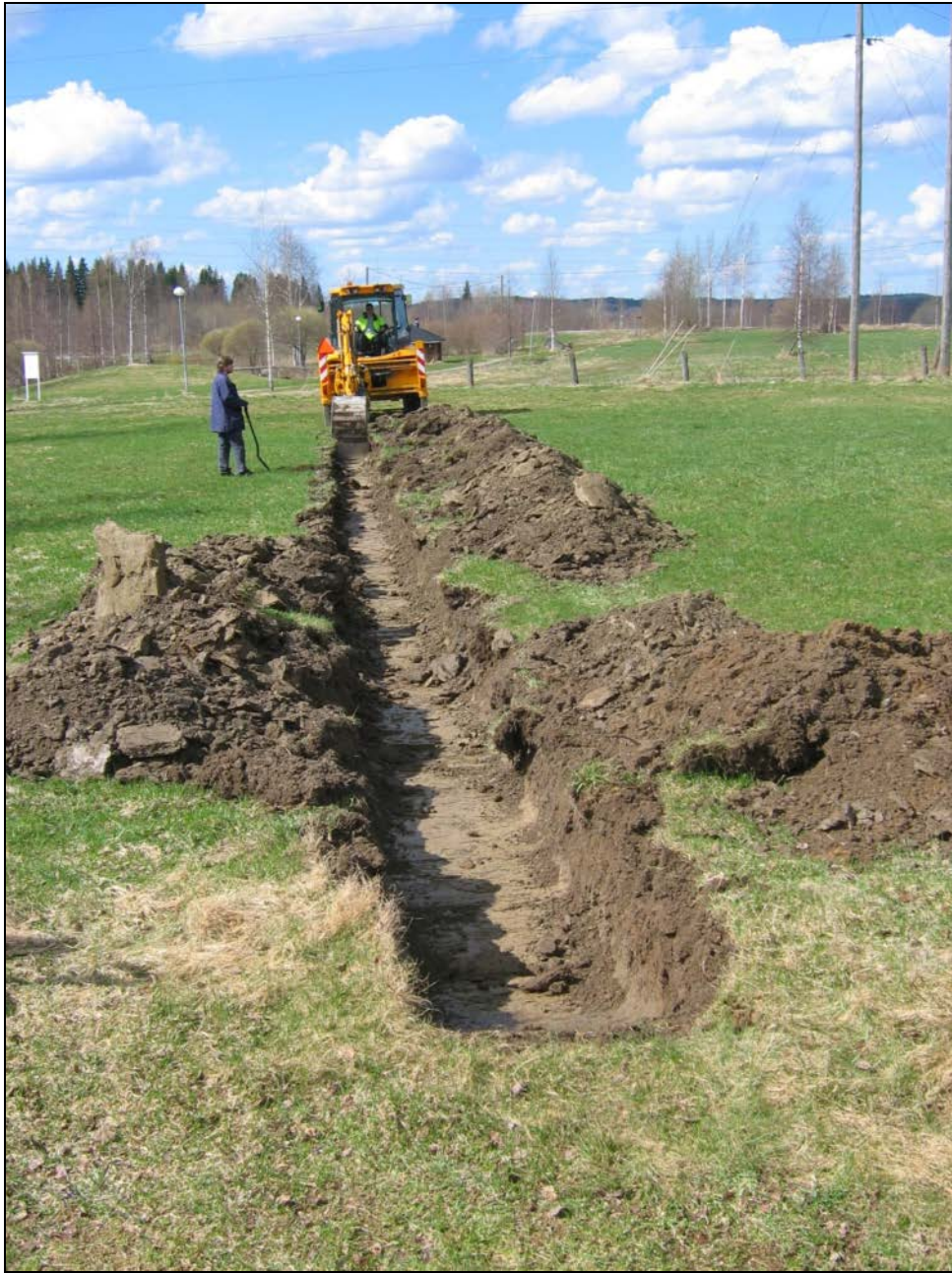
Koejaa 9 kaivetaan leirintäalueen veistokentällä. Veistokentän koejissa ei näkynyt mitään arkeologisesti merkittäviä poikkeamia. Pintamaan alta paljastui puhdas pohjamaa. Taustalla olevalla alueella sijaitsee Sakari Pälsin tarkastama venäläisten kaatuneiden kenttäkalmisto.
