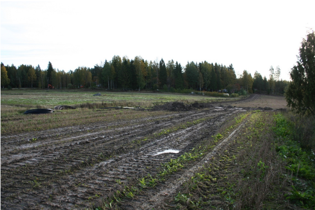
DG2230:1 Yleiskuva Kestikievarin itäpuolisista pelloista. Vesihuoltolinja kaivettu keskellä. Länsilounaasta. Kuvaaja Anu Lempiäinen.
