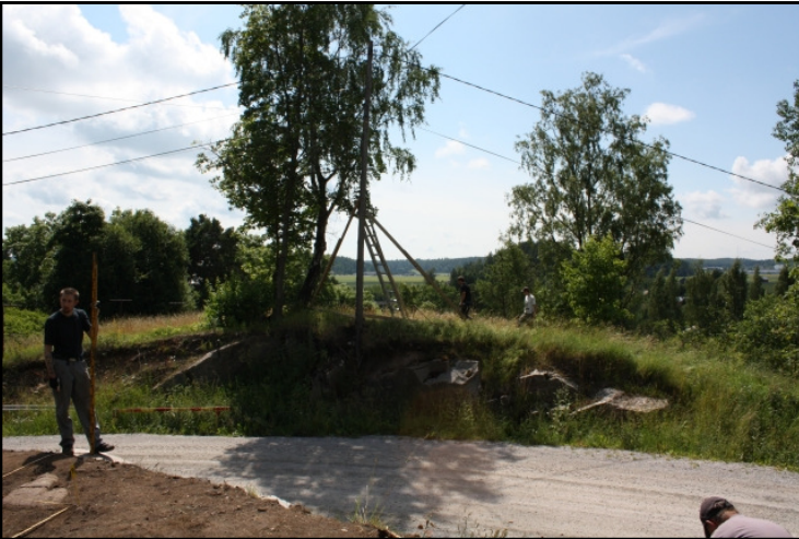
DG1141:80 Työkuva tienleikkauksen eteläpuolella roikkuvan sähkötolpan tukemisesta kuvattu pohjoisesta kuvaaja Esa Mikkola
