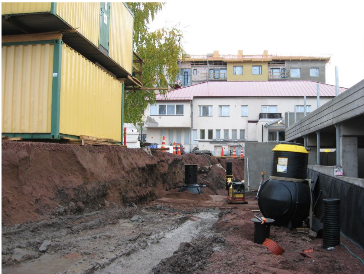
Kuva 18: Paalukaivanto 1:n luoteinen laajennus vaiheessa, jolloin alueelle kaivettiin kaivoja. Oikealla kuvassa näkyy rakenteilla olevaa pysäköintihallin elementtiseinää. SW.
