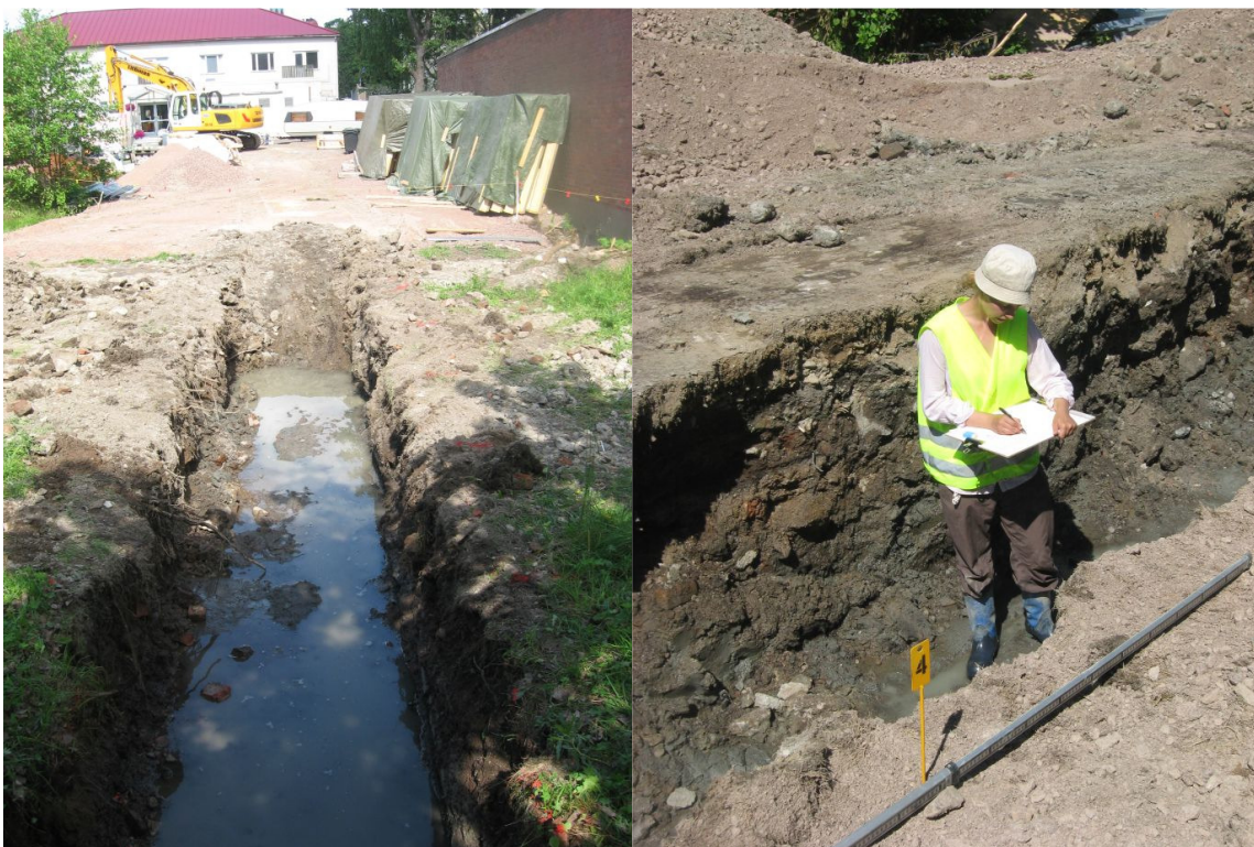
Kuvat 12-13: Vasemmalla koeojan 3 SW-puolisko koeoja 2:een kiinni kaivettuna (SW). Myöhemmin kaivettu koeoja 3:n NE-pää ulottui osittain myöhemmin avatun pysäköintihallin kaivannon alueelle. Oikealla tutkimusapulainen Lajja Simponen dokumentoi piirtämällä ojan SE-seinämää (S). Kuvat: KyM/M. Kykyri.
