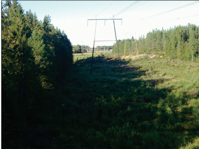
Uuden ja vanhan voimajohtolinjan yhtymäkohta. Kaukana taustalla Jylkän sähköasema
