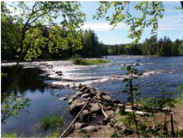
65239: Siikakoski 2 uittopato. Yleiskuva. Taustalla oikealla saari, johon Siikakoski 1 pato ulottuu. Luoteesta. J. Taivainen 22.6.2010.
