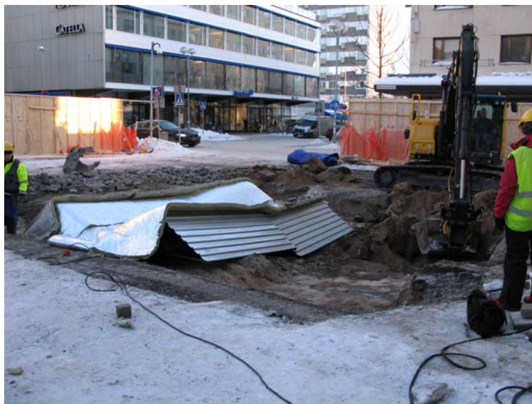
Kuva 6. DG2166:2. Uuden esiintymislavan kaivutöitä valvottiin kirpeässä pakkassäässä. Kuvassa alueen luodeosan päällä routamatot. Museovirasto, M. Hyttinen.
