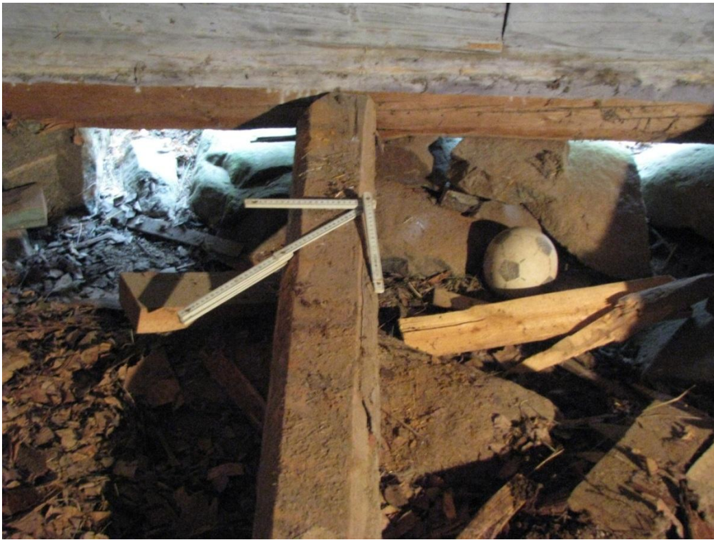
Kuva 12. Kirkon läntisessä nurkkauksessa lattia oli korkealla. Kivijalan välissä oli aukko, josta 1980-luvun potkupallo oli vierinyt lattian alle. Kuva: M. Modarress.
