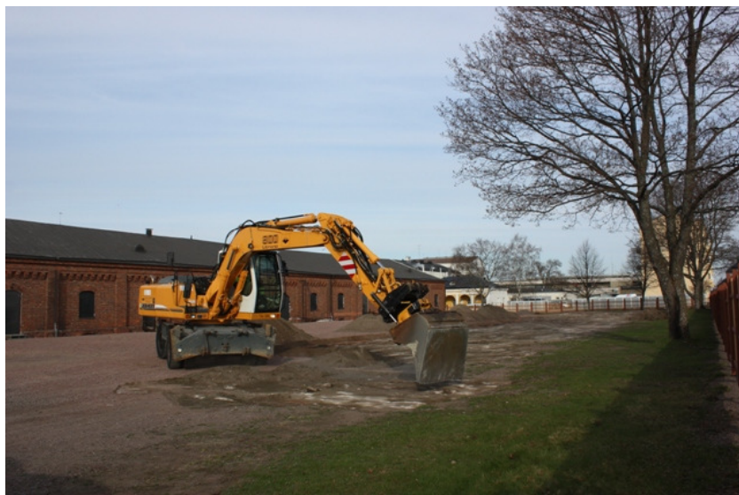
DG2224:198 Kaivausalueelta kuoritaan kaivinkoneella tasoitesorakerrosta, jonka alta tulee esiin tykkihallin betonilattian jäännökset. E-W. Kuva Katja Vuoristo.
