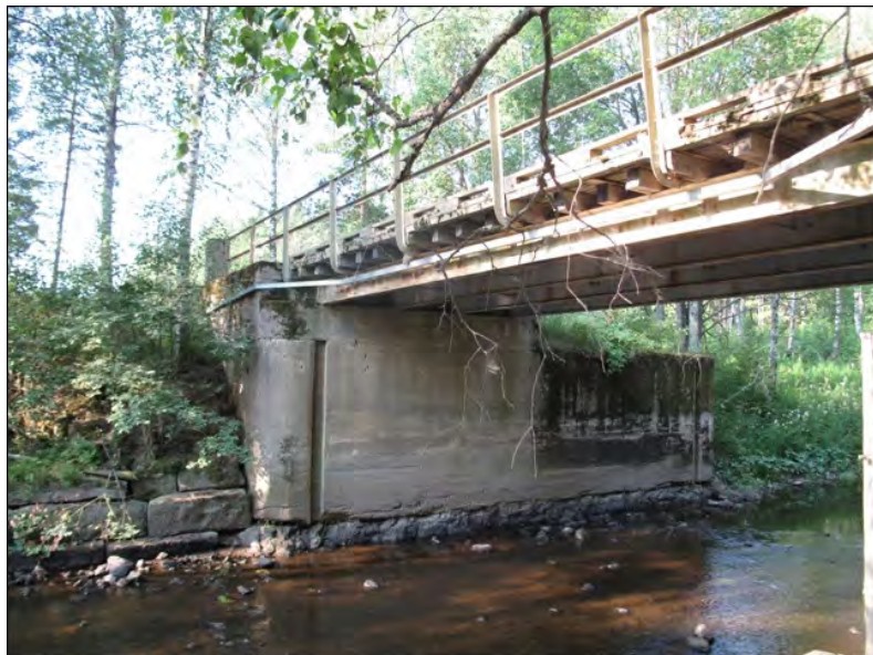
Kuva 58. Säkjärven tulvituspadon seinämää on osaksi uusittu kun padon yli on rakennettu silta. Uomaa tukevan betoniseinän päissä erottuu urat padon sulkuseiteille. Kuva: Tiina Mikkanen 2010 / Museovirasto 217984:149.
