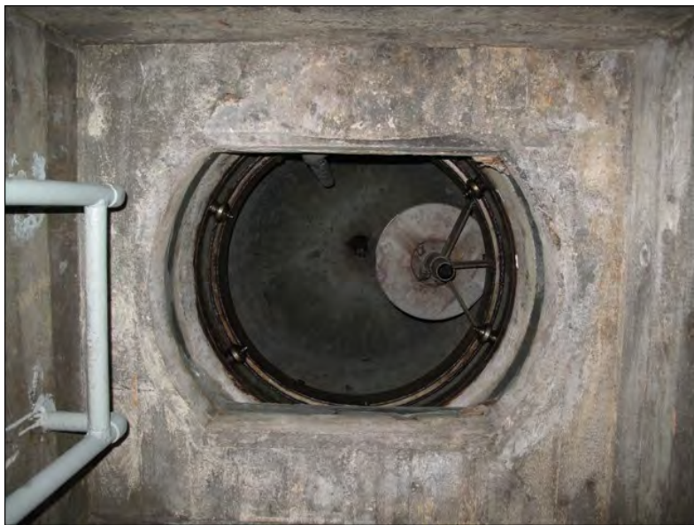
Kuva 54. Teräksinen, vuoden 1940 mallinen tulenjohtokupu alhaalta päin kuvattuna. Kuvun alareunaan on kiinnitetty tähytäjän jakkara. Kuvun huipussa on aukko tulenjohtoperiskoopille. Virolahti, Saarasjärvi, korsu 69. Kuva: Tiina Mikkanen 2010 / Museovirasto 217984:126.
