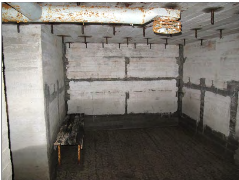
Kuva 84 Korsun C419 majoitustilan puinen sisäkatto on poistettu. Katon kiinnitykseen käytetyt teräspultit ovat paikoillaan. Kuva: Tiina Mikkanen 2010 / Museovirasto 217984:209.
