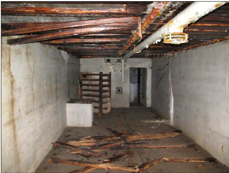
Kuva 59. Korsun 23 majoitustilan puinen sisäkatto on jo osin sortunut. Vasemmalla kaivon takana on puinen hylly, ilmeisesti panssaritorjuntatykin ammuksille. Katossa ilmanvaihtohormi, jossa on ilman hajoittaja. Kuva: Tiina Mikkanen 2010 / Museovirasto 217984:162.
