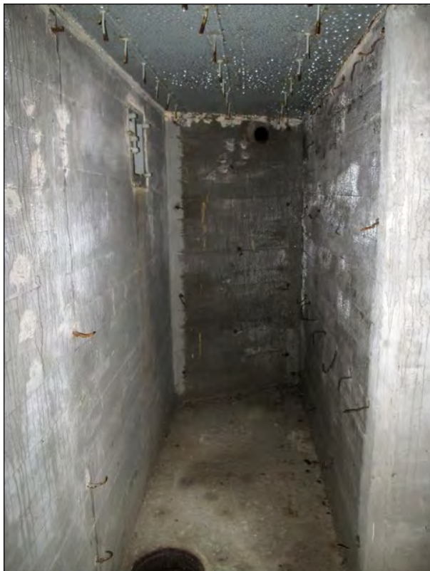
Kuva 57. Korsun 151 asekkamion tähyystytila. Vasemman puoleisessa seinässä on tähyystytilan luukun kehykset mutta itse luukku puuttuu. Katossa ja seinissä on rautalankojen pätkiä ääntä vaimentavien akustiikkamattojen kiinnitykseen. Virolahti, Hytti. Kuva: Tiina Mikkanen 2010 / Museovirasto 217984:152.
