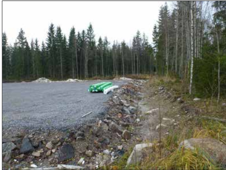
Latomus keskellä oik. penkassa noin vihreiden putkien tasalla
