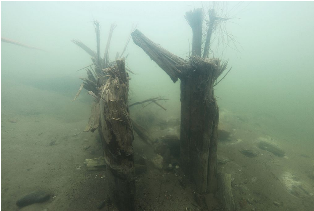
Kuva 4. Vaurioituneet pystypuut patorakenteen ulkolinjalla. Kuva: Museovirasto MA201111:43.
