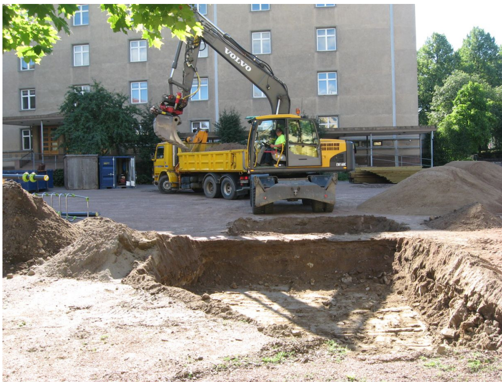
Kuva 11: Monitoimitelinettä varten kaivettu perustuskuoppa K3, jonka seinämän alaosassa (oikealla) erottuu alueen täyttämiseen käytettyä lohkokiveä. NW.
