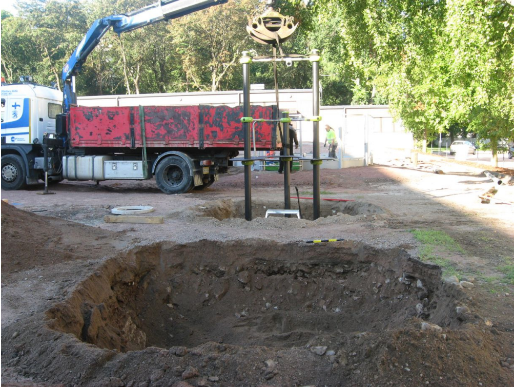
Kuva 9: Telinekaivanto K2 pohjaan kaivettuna (etualalla). Taustalla asennetaan köysiratatelineettä kaivantoon K1. NE. Kuva: KyM/M. Kykyri.
