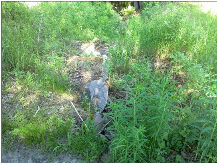
Kivistä tehty osin rikkoutunut siltarumpu Melasenrannan eteläpuolella.
