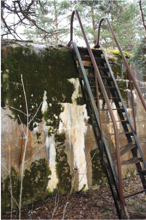
DG 2631:16 Betonivarustuksen itäosan pohjoisseinän kalkkivalumia ja sammaloitunutta seinää. N-S. Kuva Katja Vuoristo.
